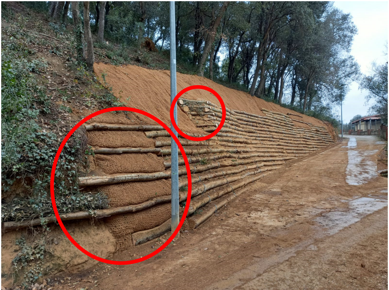
Exemple d'unió-trobada entre palissada amb loricata i terreny existent amb un enreixat simple i protecció de la malla de coco, realitzat a l'Oficina de Collserola
