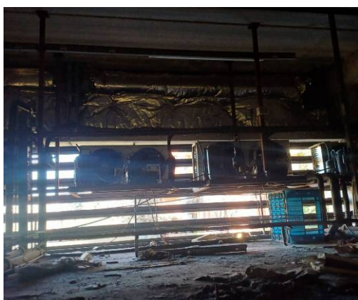
Unitats exteriors existents, compressors
