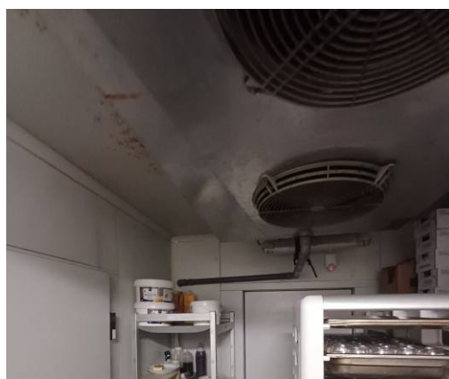
Unitats interiors en càmera frigorífica existent.
