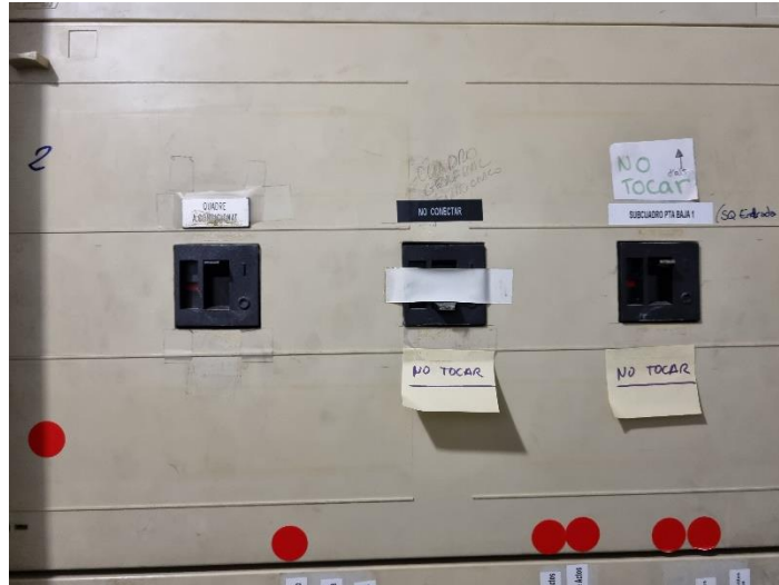
Quadres elèctrics existents (punt de connexió)
