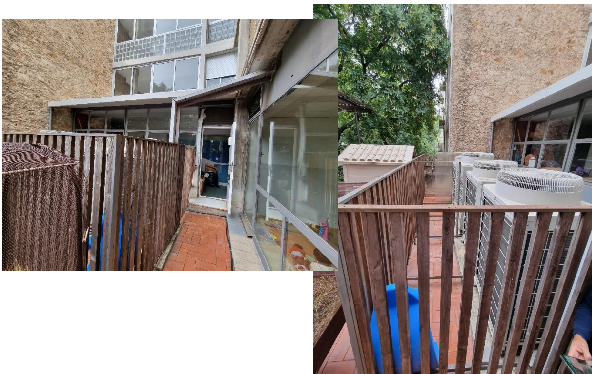
Emplaçament previst per nova maquinaria
