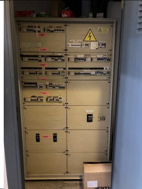
Quadre elèctric existent a la zona d'entrada de l'edifici vell
