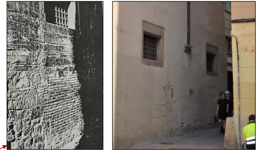
A sobre, vista d'una fotografia del tapiat de maó massís de l'obertura situada al darrer eix de finestres de la construcció (segons l'expedient de reforma de 1988) i estat actual, amb la tàpia oculta rere el revestiment més contemporani. Font: AMDCV.
