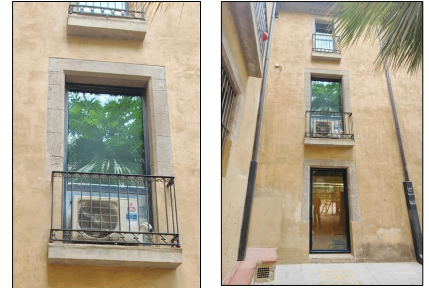
Detalls d'alguna de les obertures de la façana nord al pati de l'escola.
