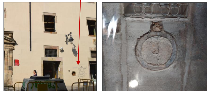
Planta de l'espai, en negre l'espai que es segregaria al 1916. Planimetria per Antoni de Falguera a 1916 i comparativa de l'estat del torn actualment i abans de la realització d'una campanya d'obres al 1988 en que s'intueix la finestra oberta al segle XX, actualment cancel·lada. Font: AHCOAC i AMDCV.
