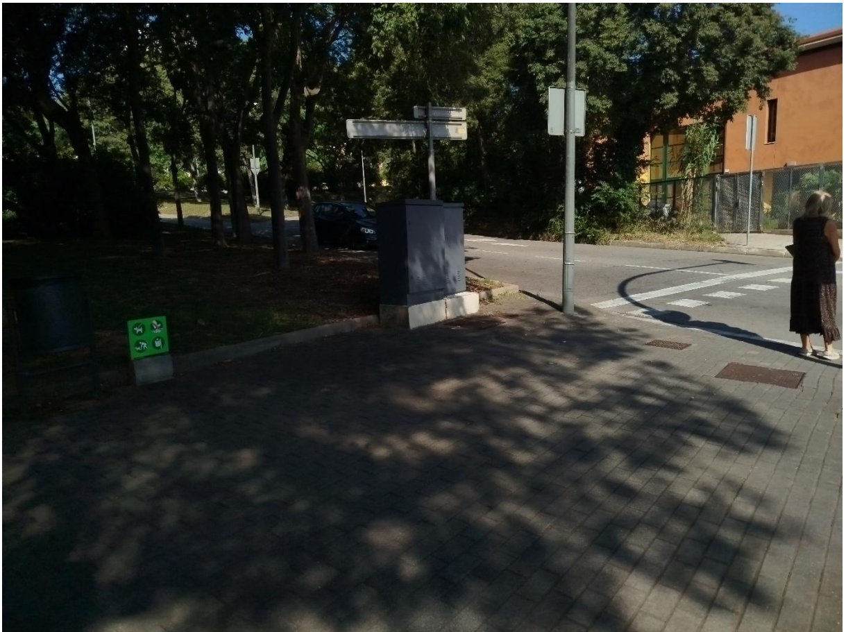
Imatge 8: Armari regulador existent a la cruïlla del carrer Jorge Manrique-Arquitecte Moragas
