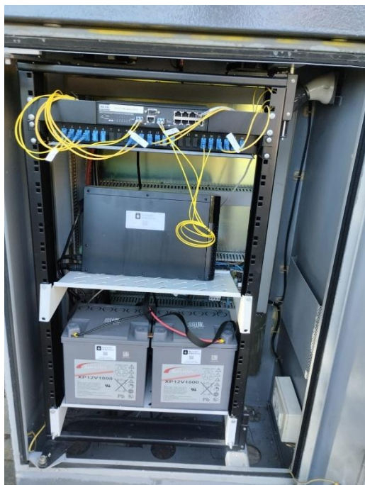
Imatge 93: Vista interior armari regulador existent a la cruïlla del carrer Jorge Manrique-Arquitecte Moragas. Comunicacions
