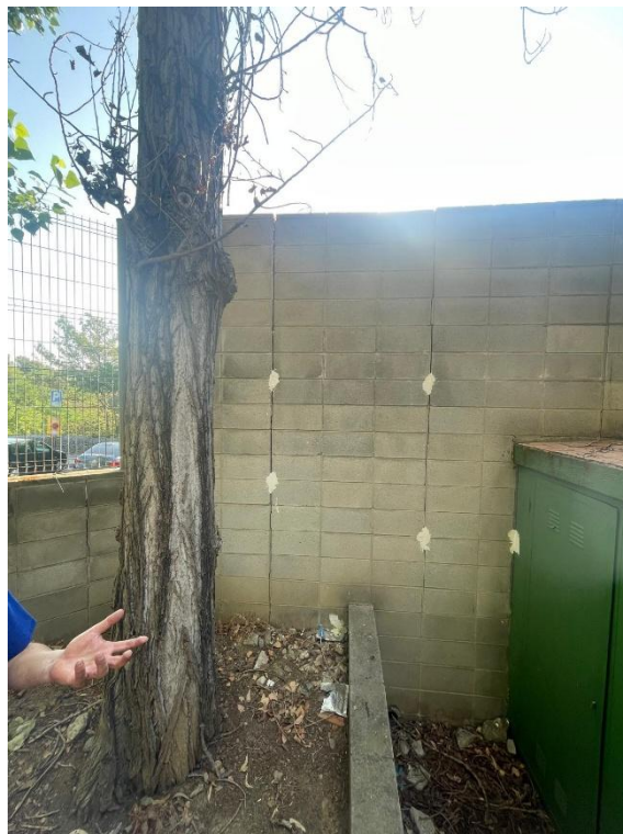
Mur de cantonada vist des de l'interior. S'observen esquerdes que travessen el mur.
