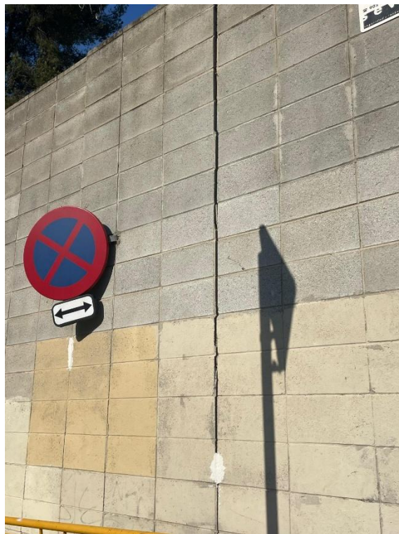
S'observa esquerdada i desplom del tram de mur.
