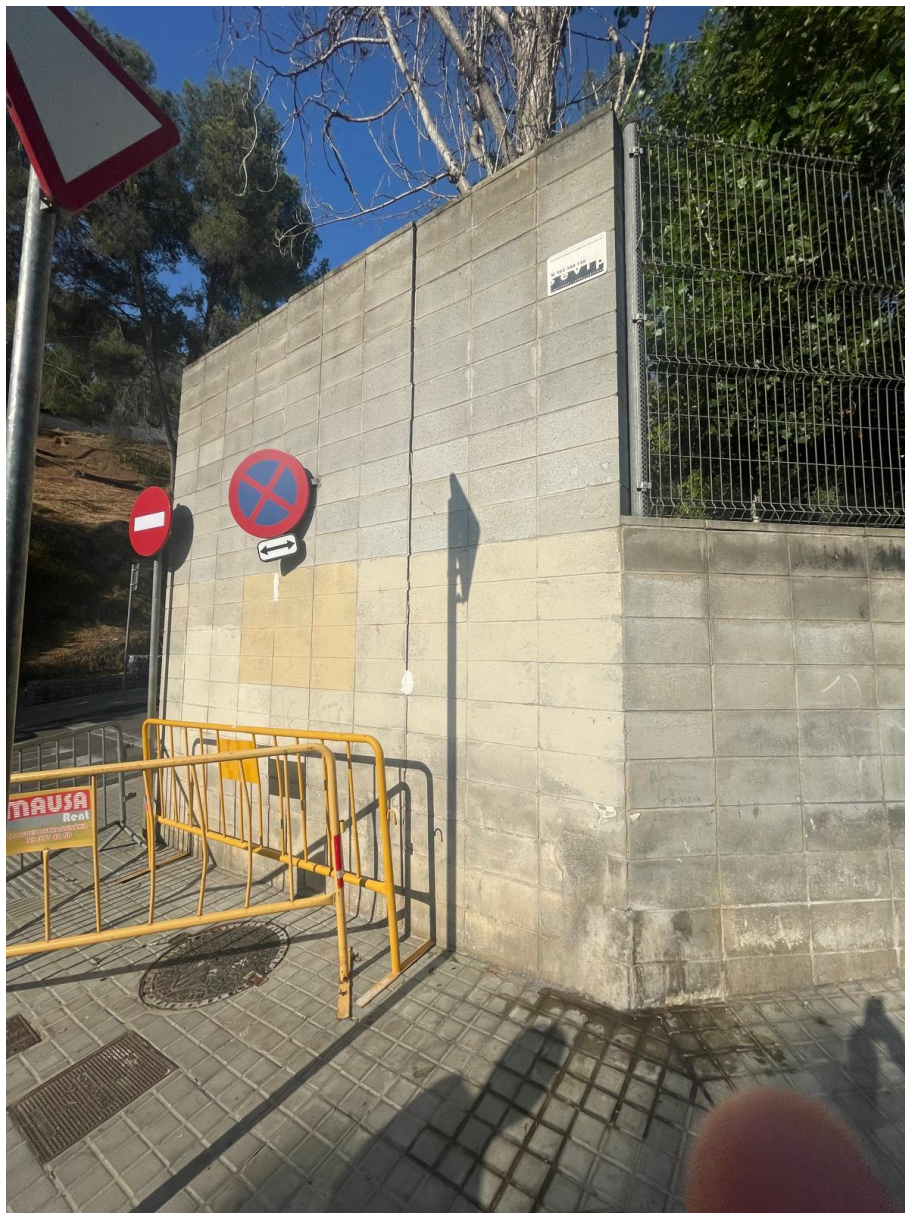
Fotografia del mur afectat, on s'aprecien les patologies
