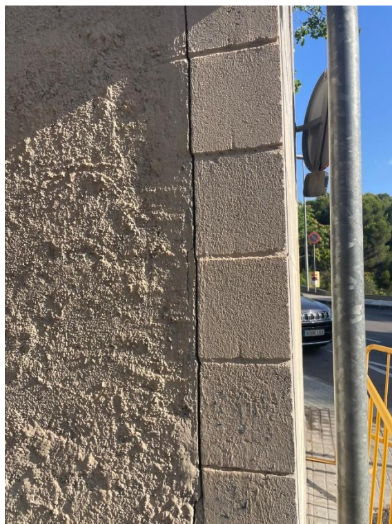
Trobada esquerdada entre mur de blocs de formigó i mur arrebossat.
