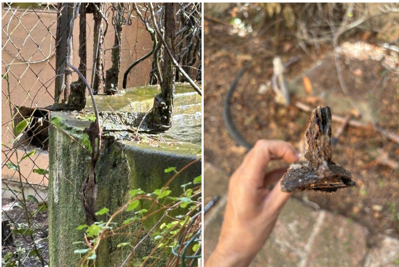
Imatges 240201-44 i 220830-02. Exemples de l'estat de deteriorament dels muntants verticals de la pèrgola de l'estany dels lleons.
