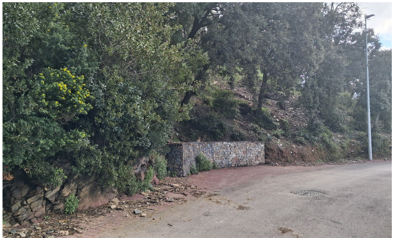
Carrer d'Orellana on hi ha arrossegaments procedents de la parcel·la 01. Àmbit 01
