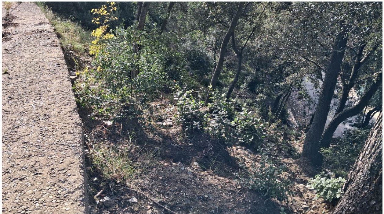
Estat del talús de la parcel·la 01, adjacent a la vorera. Àmbit 01
