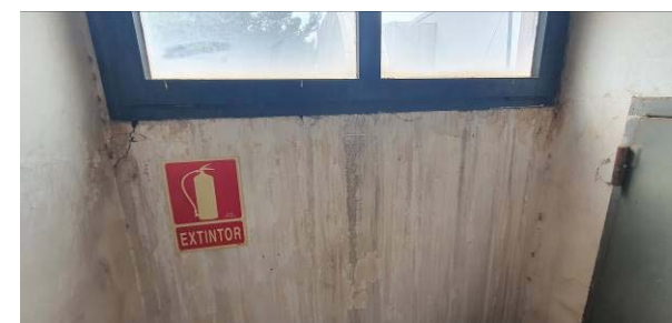
Filtracions d'aigua per fusteria de fusta
