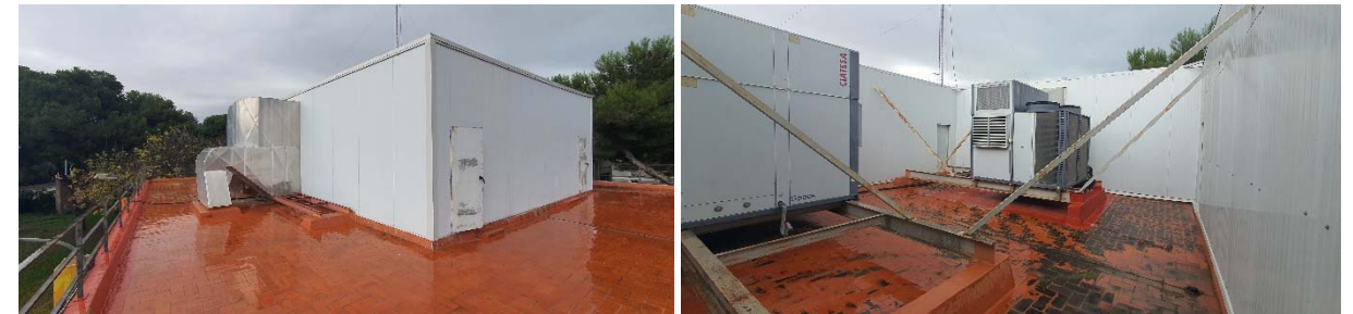
Planxes sandvitx arrenquen d'un muret recrescut en coberta. El remat de la part inferior en l'exterior reté l'aigua que arriba per escorrentia i s'acumula en l'interior de la cambra provocant possibles filtracions. En la part interior hi ha un remat inferior que evita les filtracions per escorrentia. Els coronaments dels tancaments no estan degudament solapats i poden ser punts d'origen de filtracions.
