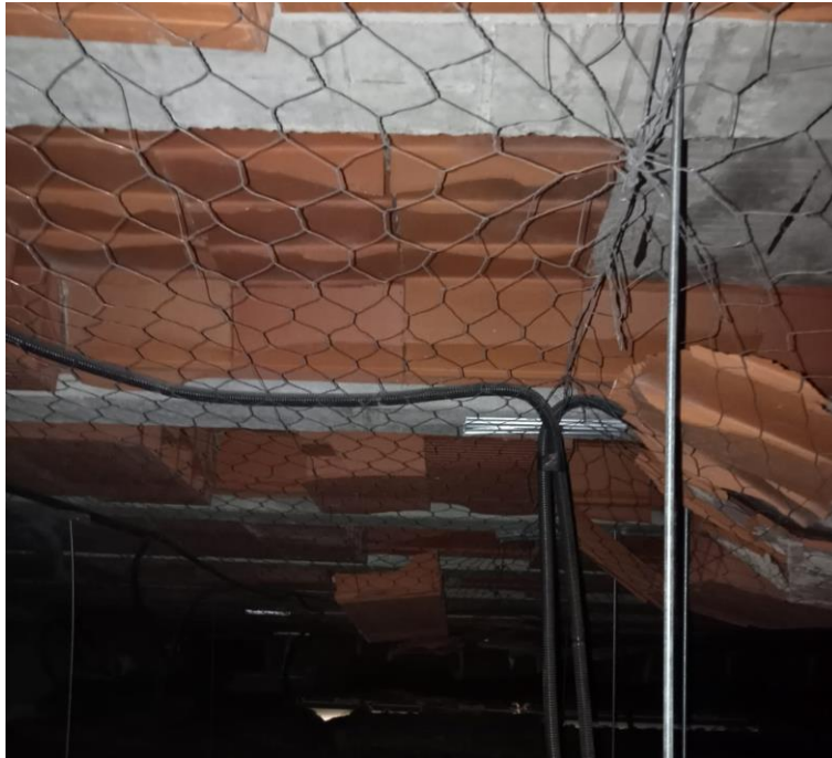
Estat revoltans abans col·locació xarxa protectora (1)
