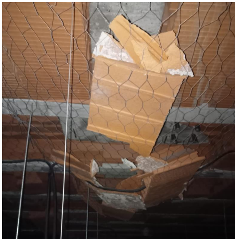
Estat revoltans abans col·locació xarxa protectora (2)
