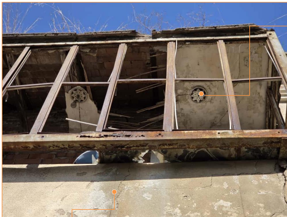
Barana del balcó de la tribuna cega revestida amb estuc i amb juntes de punxó verticals i textura rentada per simular plafons de pedra.
