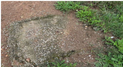
Punto sin anclaje 1
