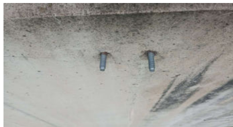
Ejemplo de anclaje sustraído
