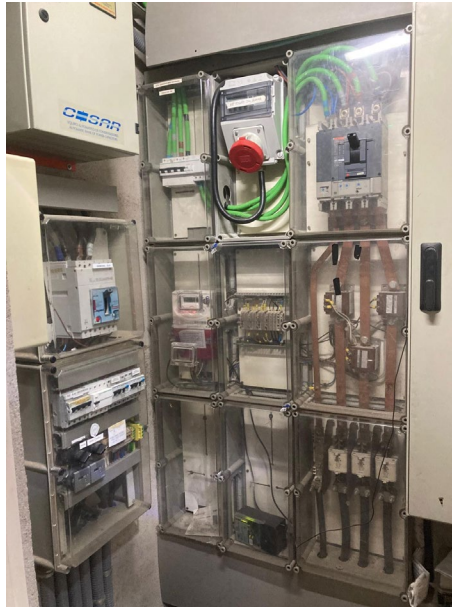
TMF10 Consum ubicada en ST interior
