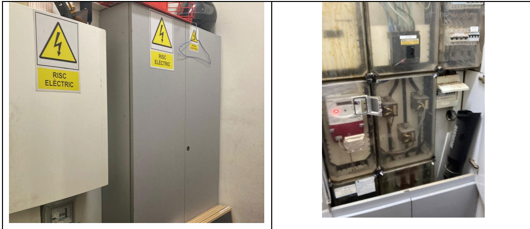
TMF Consum en armari sala tècnica interior
