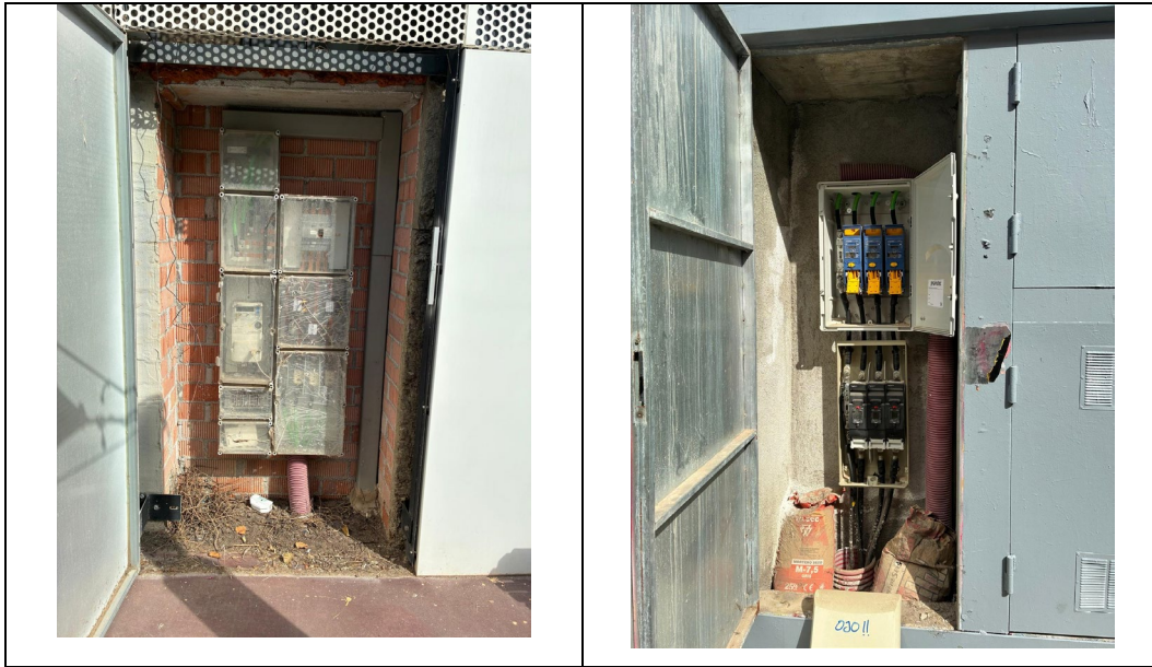
TMF Consum en nínxol façana pati interior. CS i CGP en façana tancament de pati
