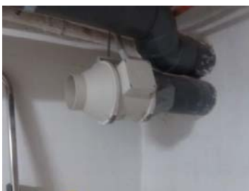
Imatge 52: Extractor conducte planta soterrani
