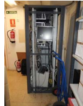
Imatge 11: Rack telefònic Planta baixa
