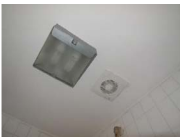
Imatge 51: Extractor sala abocador
