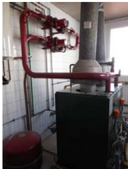
Imatge 33: Sala de calderes
