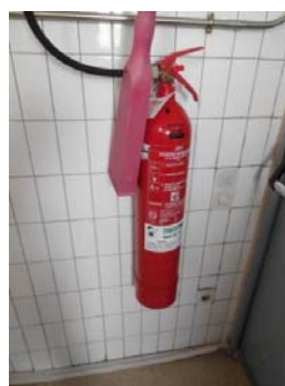
Imatge 66: Extintor CO 2
