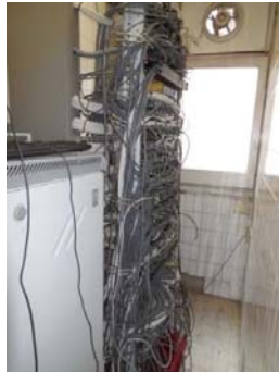
Imatge 10: Rack Planta 5
