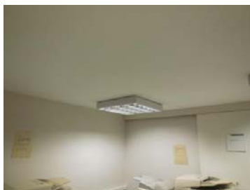
Imatge 26: Enllumenat fluorescent de superfície
