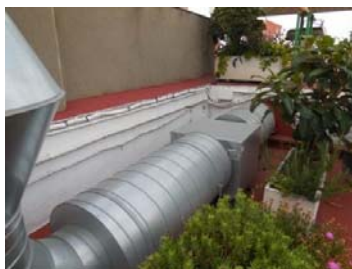
Imatge 49: Ventilador extractor planta cinquena
