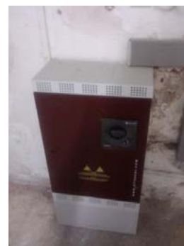
Imatge 4: Bateria condensadors
