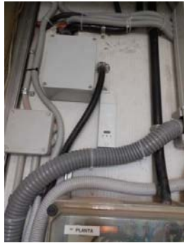
Imatge 39: Termòstat caldera
