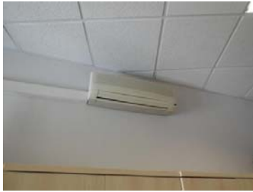
Imatge 44: Unitat interior tipus split
