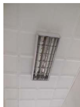
Imatge 25: Enllumenat fluorescent de superfície
