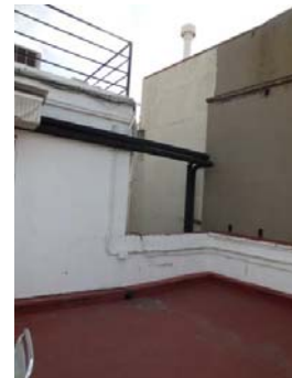
Imatge 35: Muntant calefacció a Planta sisena
