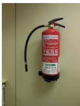
Imatge 65: Extintor pols ABC
