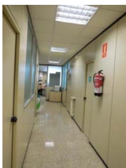
Imatge 23: Enllumenat fluorescent planta
