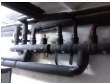
Imatge 36: Col·lector calefacció Planta soterrani
