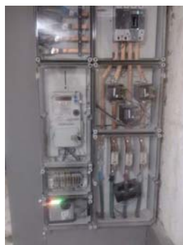
Imatge 3: Centralització comptador
