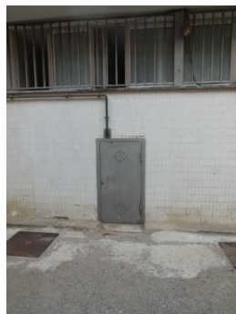
Imatge 20: Armari comptador de gas
