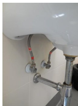
Imatge 28: Connexió hidràulica a lavabo
