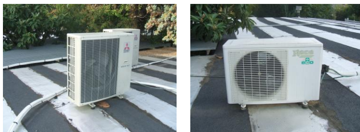
Imatge 14: Unitats exteriors a coberta (2008)
