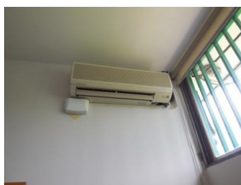
Imatge 16: Unitat interior amb bomba de condensats – Despatx 5
