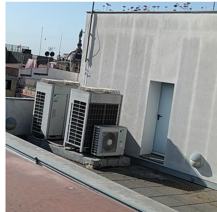
Ubicació coberta i maquinària exterior
