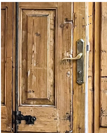
Estat inicial sistema obertura
