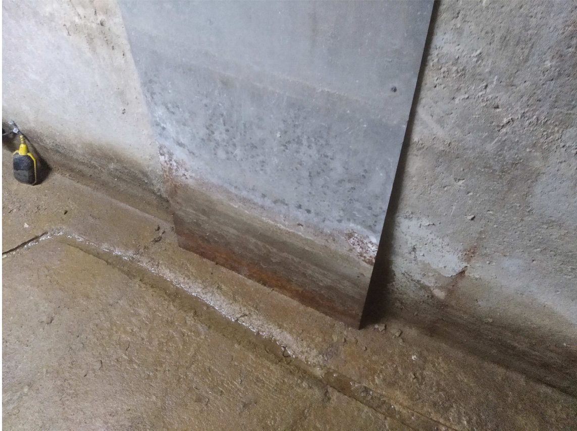
Galeria de Serveis 44. Estat actual de la junta entre mòduls prefabricats.
