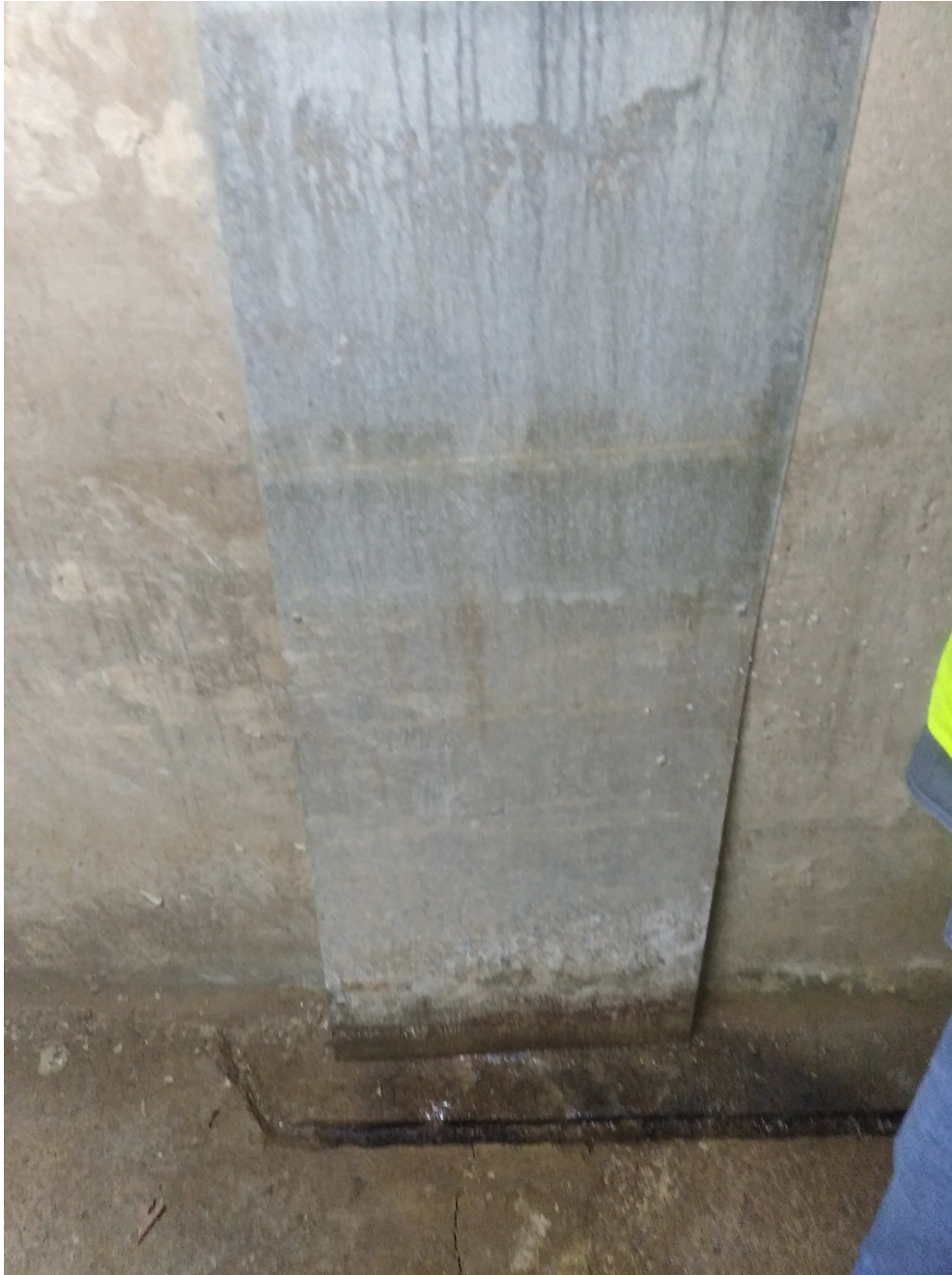
Galeria de Serveis 44. Estat actual de la junta entre mòduls prefabricats.
