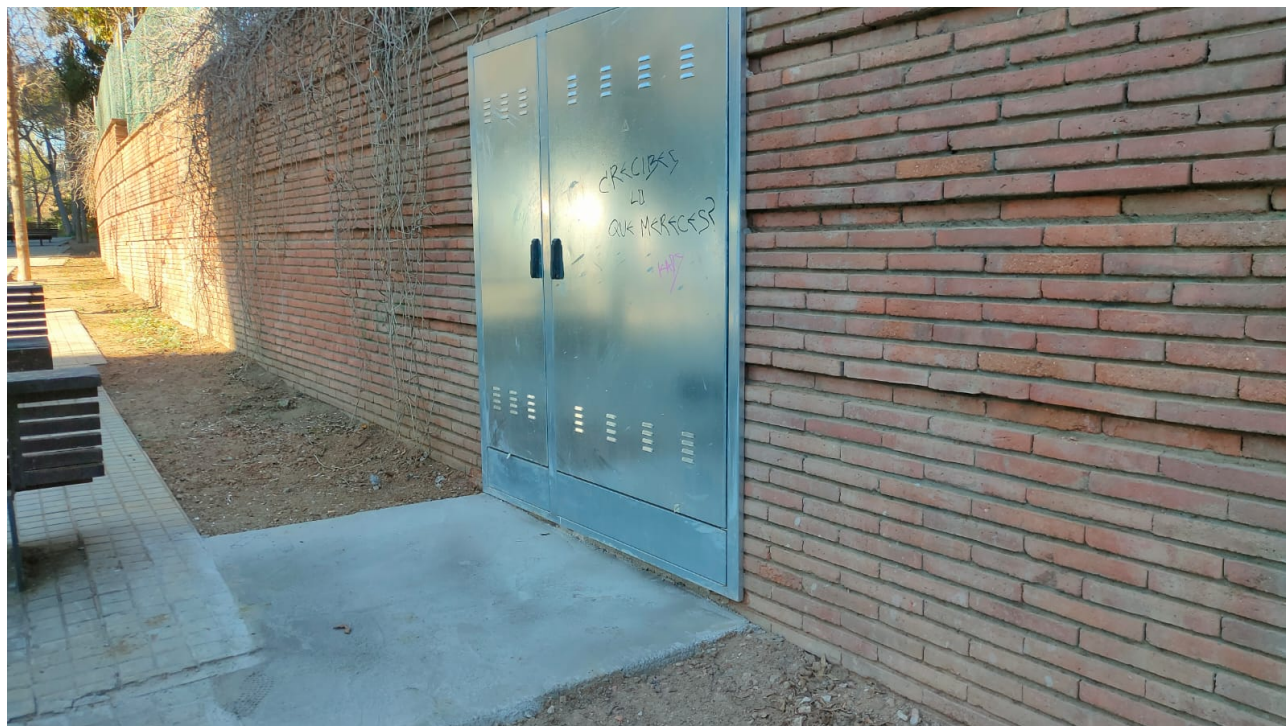
▲ Zona pavimentada davant d'armari elèctric
