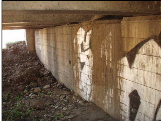
Figura 4.42.1. Filtraciones, humedades en paramento de estribo por falta de impermeabilidad de junta de dilatación.
