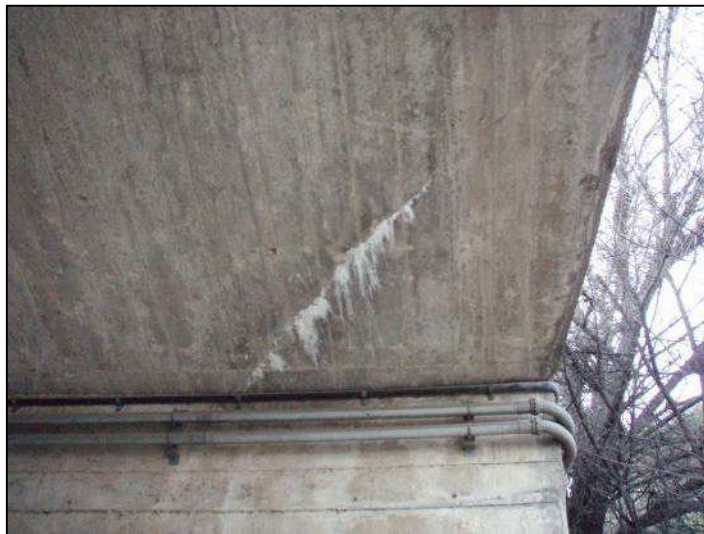
Figura 4.45.4. Fisura en esquina de dintel de marco con esviaje.
