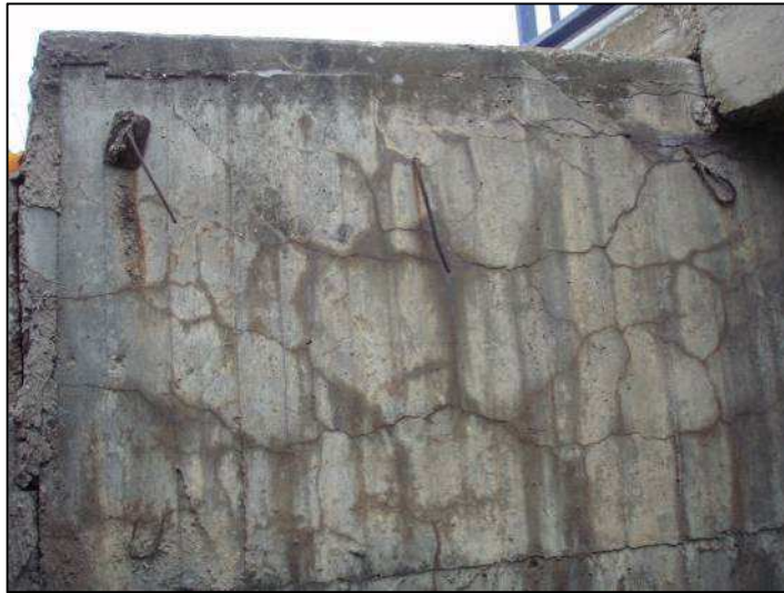
Figura 4.45.14. Fisura por ciclo hielo-deshielo en paramento de aleta.
