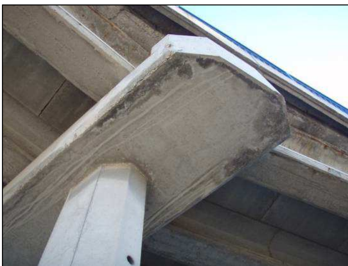
Figura 4.45.12. Fisura por corrosión de armaduras en cargadero.
