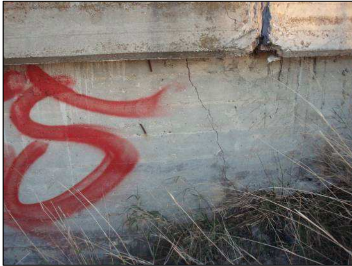
Figura 4.45.4. Fisura inclinada en aleta de estribo.
