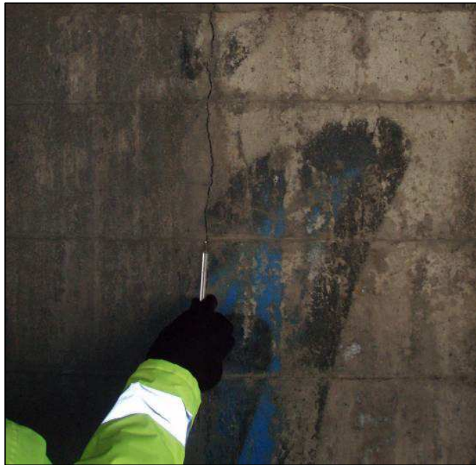
Figura 4.45.11. Fisura vertical por retracción en muro frontal de estribo.
