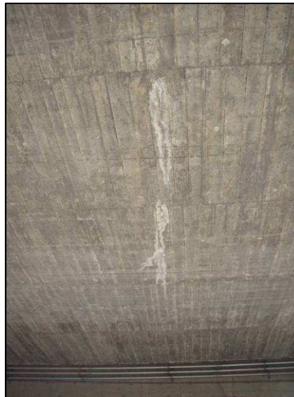
Figura 4.45.9. Fisura longitudinal en cara inferior de losa.
