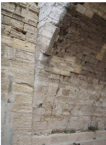
Figura 4.1.1. Alteración superficial por filtraciones y/o acción climática.
