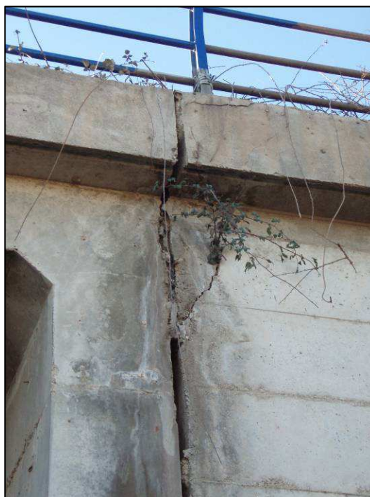
Figura 4.65.2. Vegetación en paramento de muro lateral.
