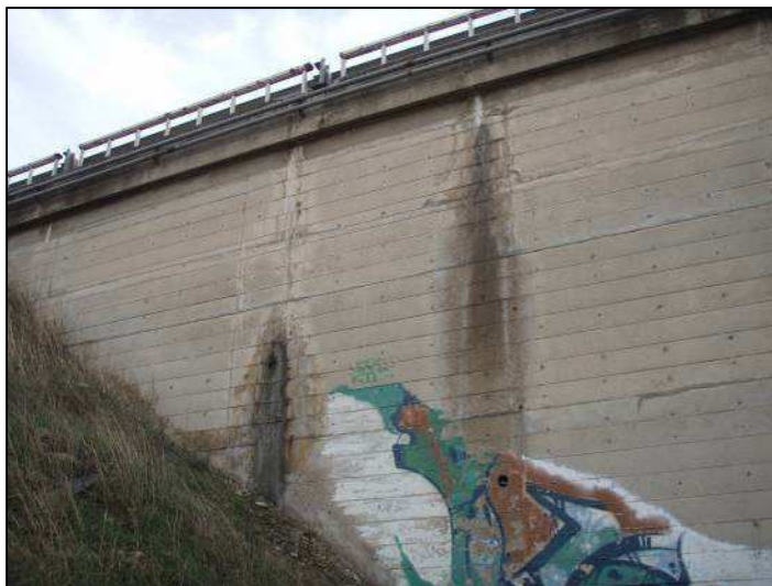
Figura 4.45.6. Fisura por asentamiento de muro lateral.
