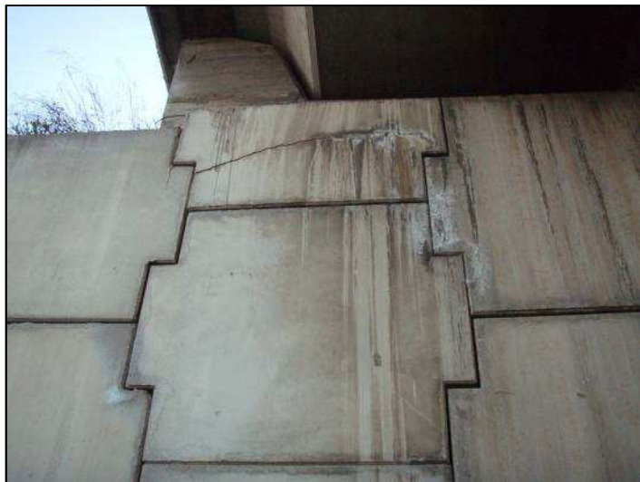
Figura 4.45.14. Fisura en fila superior de escamas de muro de tierra reforzada.
