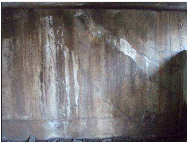
Figura 4.45.5. Fisuras en murete de guarda.
