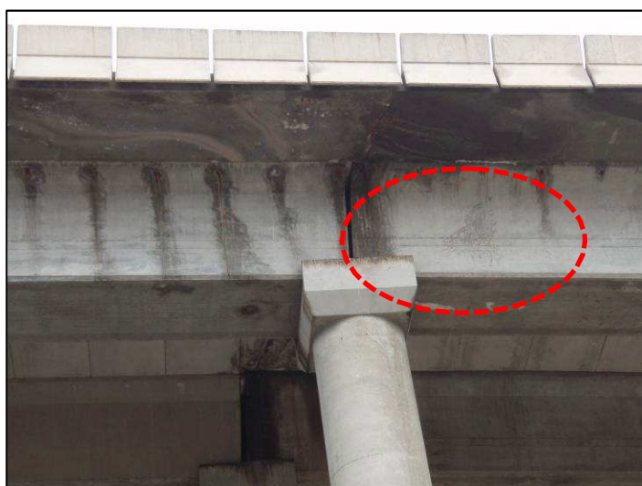
Figura 4.45.2. Fisuras a 45° en vigas.
