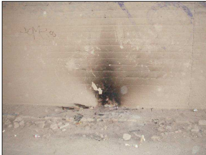
Figura 4.1.2. Alteración superficial por ataque por fuego en muro de hastial.
