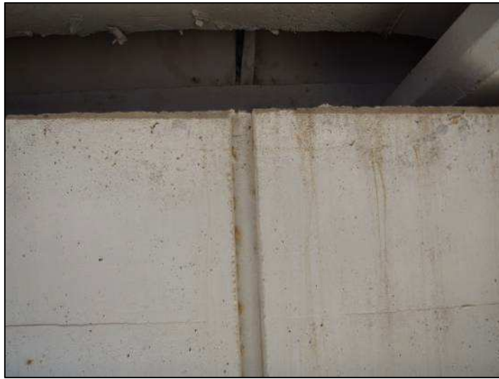
Figura 4.45.8. Fisura horizontal en cargadero de estribo.
