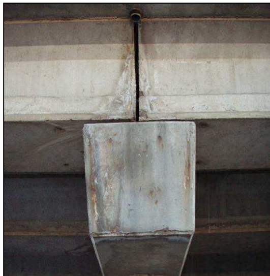
Figura 4.42.2. Filtraciones, humedades en almas de vigas y cargadero de pila por falta de longitud de gárgola.
