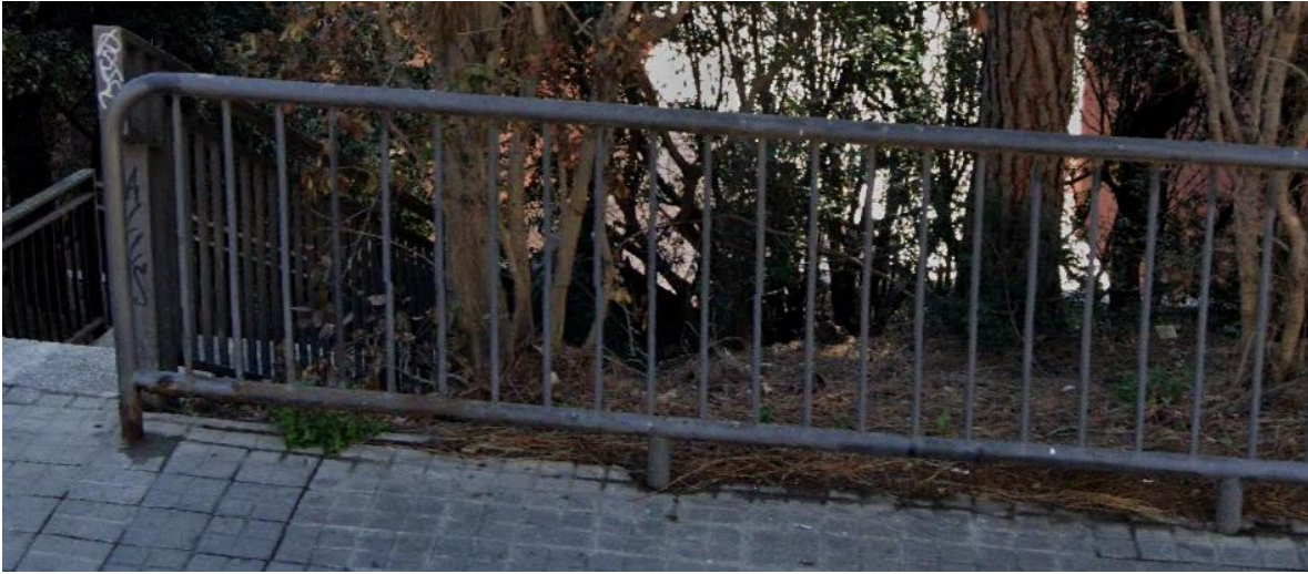
Barana existent a substituir trams.
