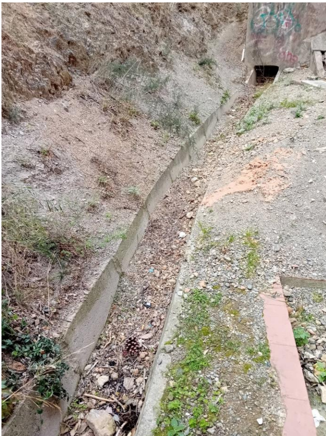
Acumulació de terres, runes i vegetació en canal de formigó.
