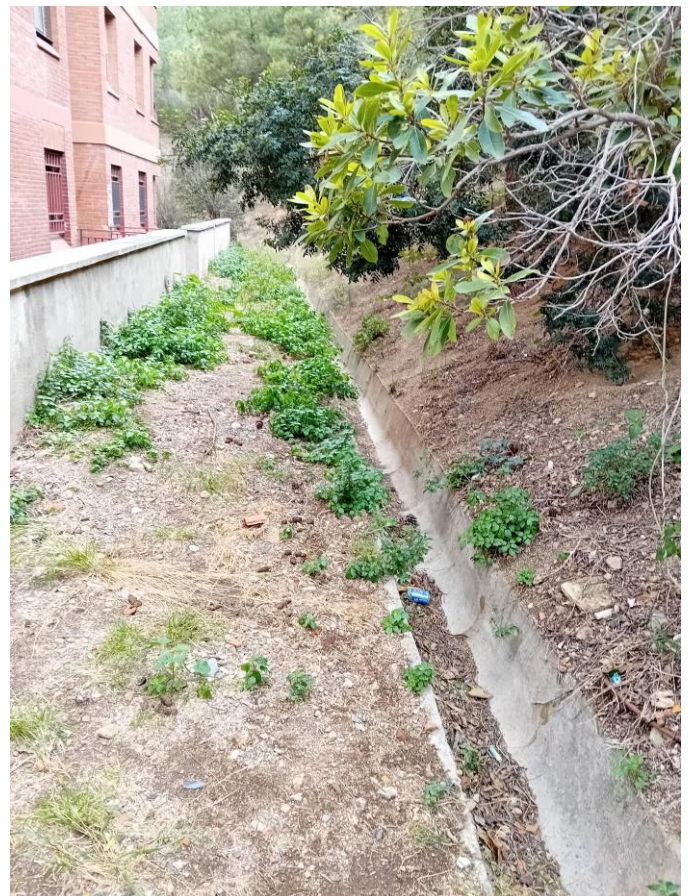
Acumulació de terres, runes i vegetació en canal de formigó i vista arbrat a podar
