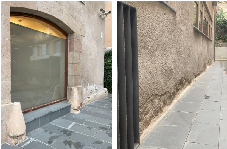
Despreniments dels cilindres de protecció
