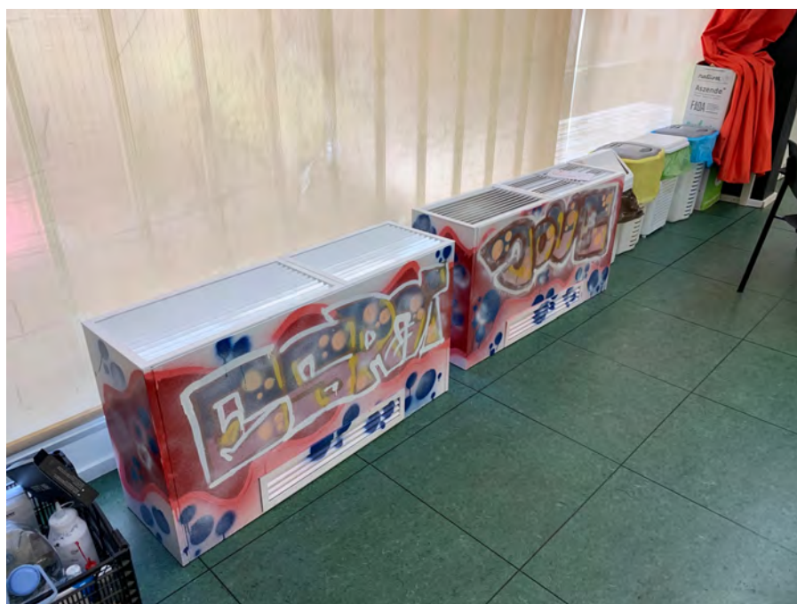
▲ Vista ventilo convectors existents al Centre.
