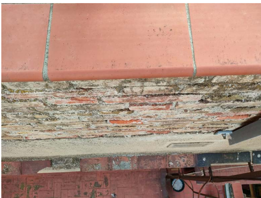
ESTAT DELS REVESITMENTS DE LES PARETS MITGERES I FAÇANES
