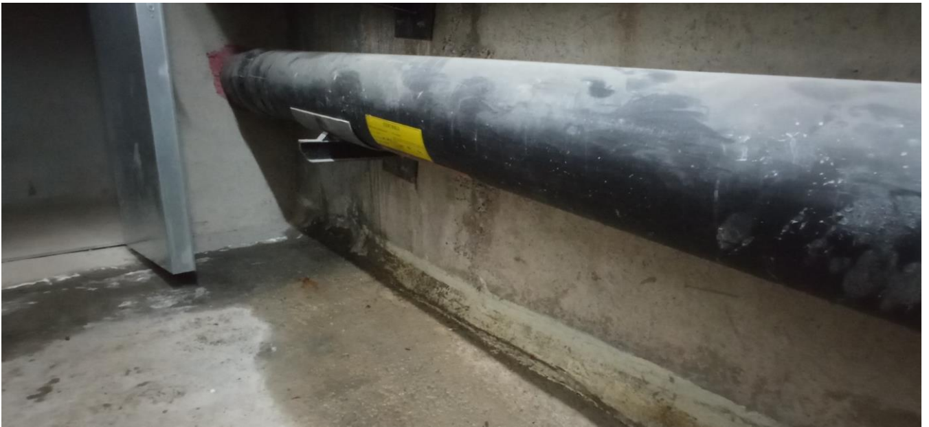
Galeria de Serveis 32. Detall d'humitat en solera.
