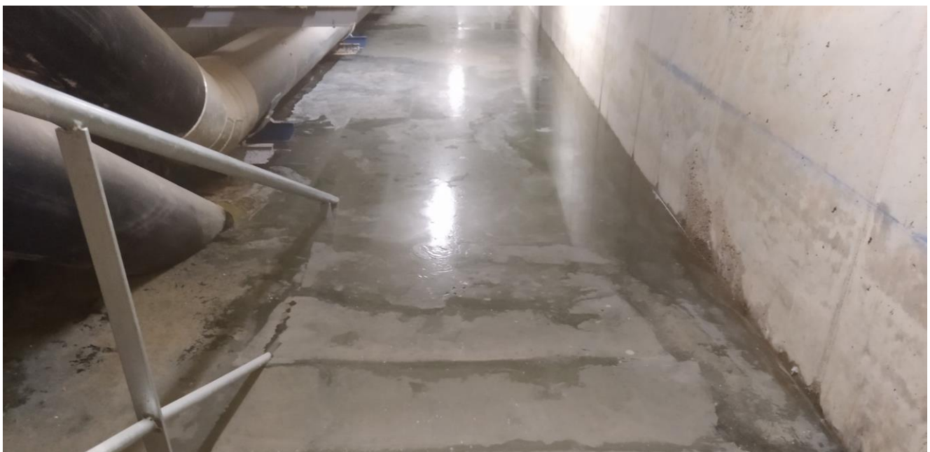
Galeria de Serveis 28. Detall d'inundació de la galeria.
