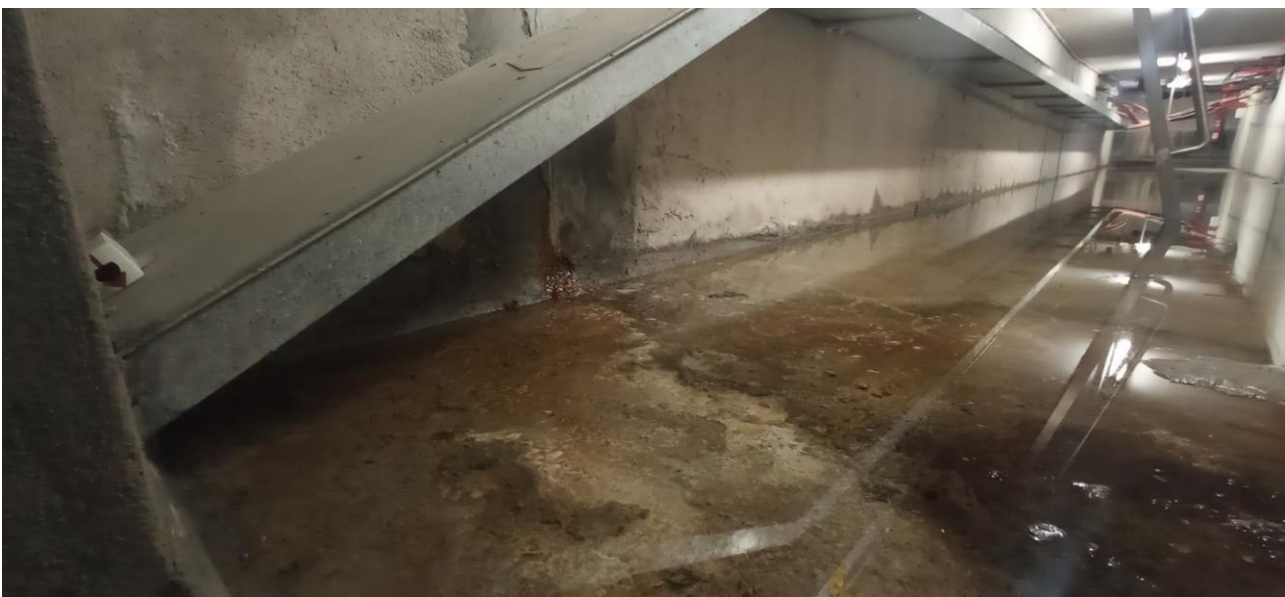
Galeria de Serveis 34. Detall d'inundació de la galeria.
