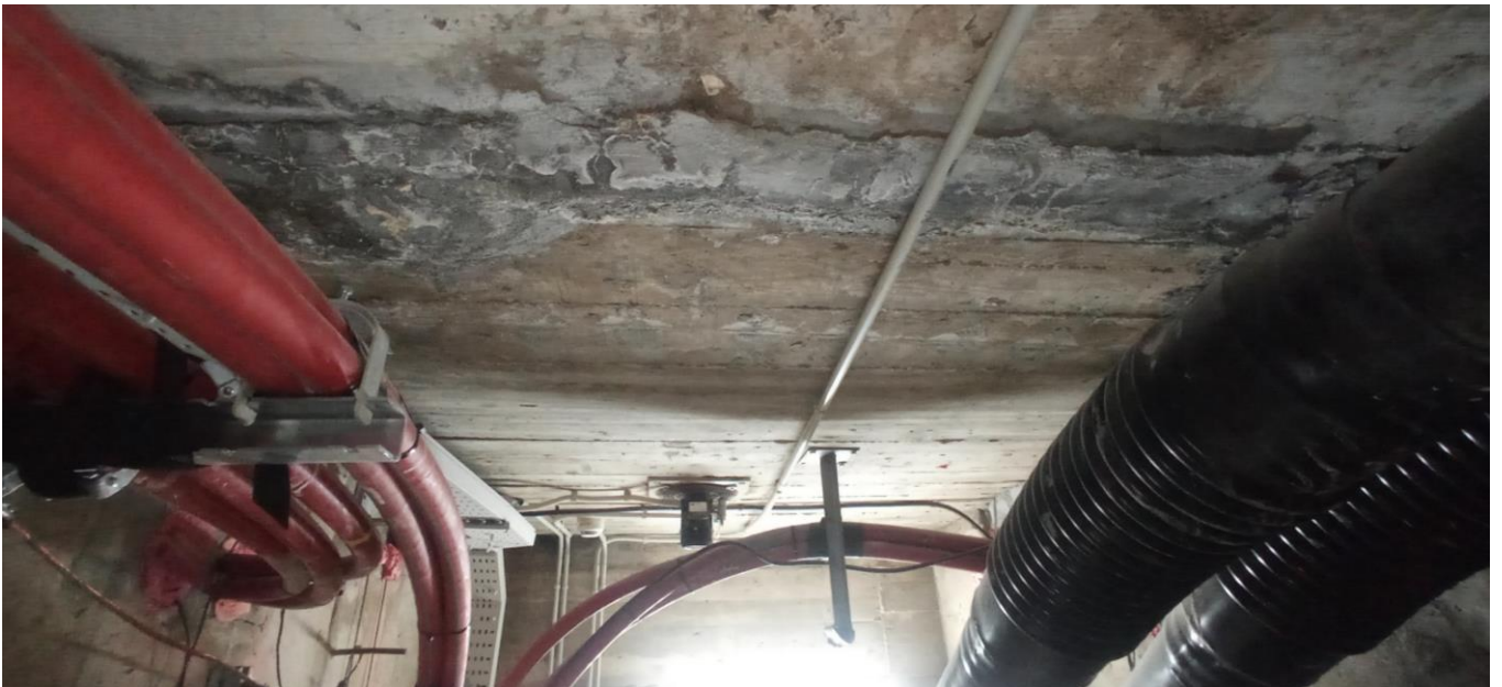
Galeria de Serveis 32. Detall d'humitat en el sostre de la galeria.
