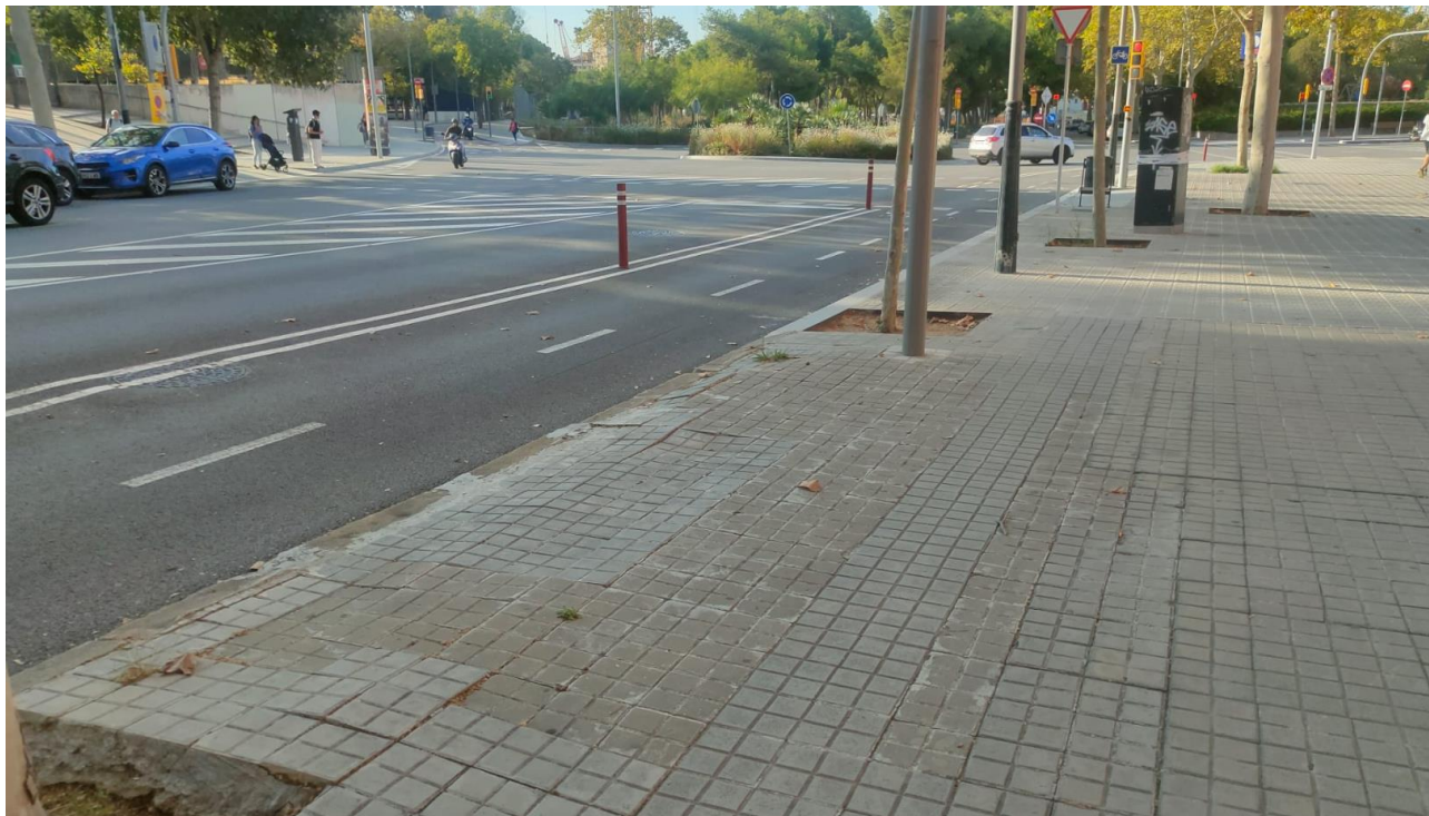
▲ Paviment deteriorat a l'entorn dels arbres
