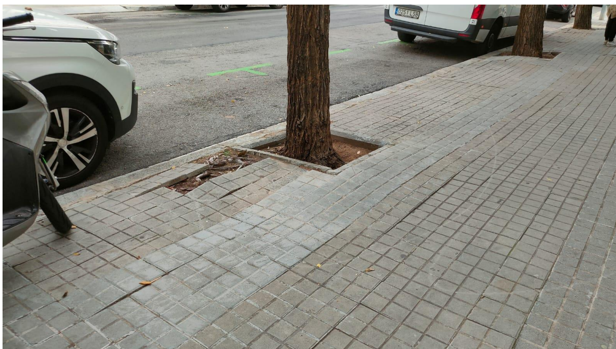
▲ Detall del paviment deteriorat a l'entorn dels arbres
