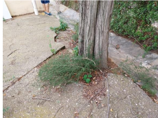
Estat general del pati de petanques. Paviments aixecats per les arrels
