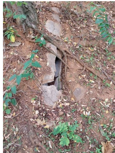
Canonada de sanejament, de formigó, a substituir.
