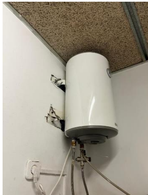
Zona cuina, termoacumulador.
