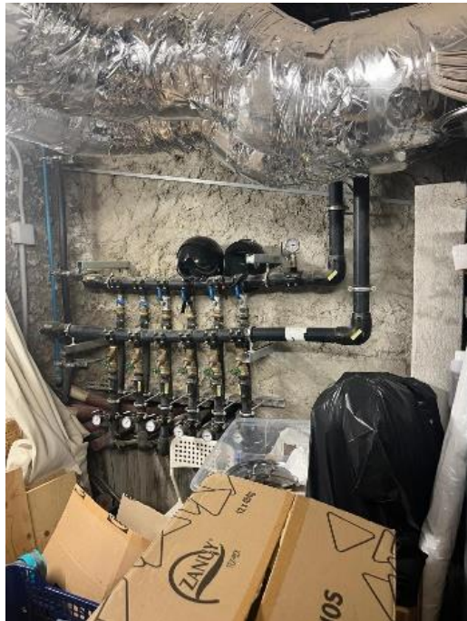
Pous geotèrmia ubicats al magatzem.
