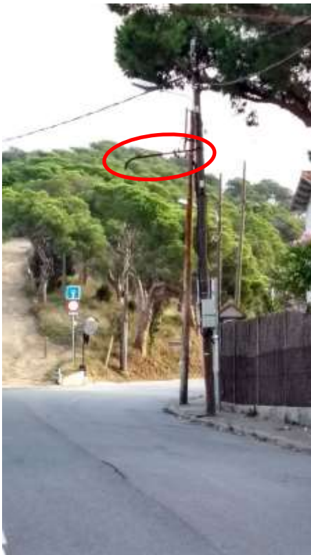
Situació de la catenària abans de les obres de reurbanització del c/ Alberes
