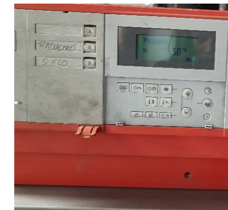
Sistema de control incorporat
