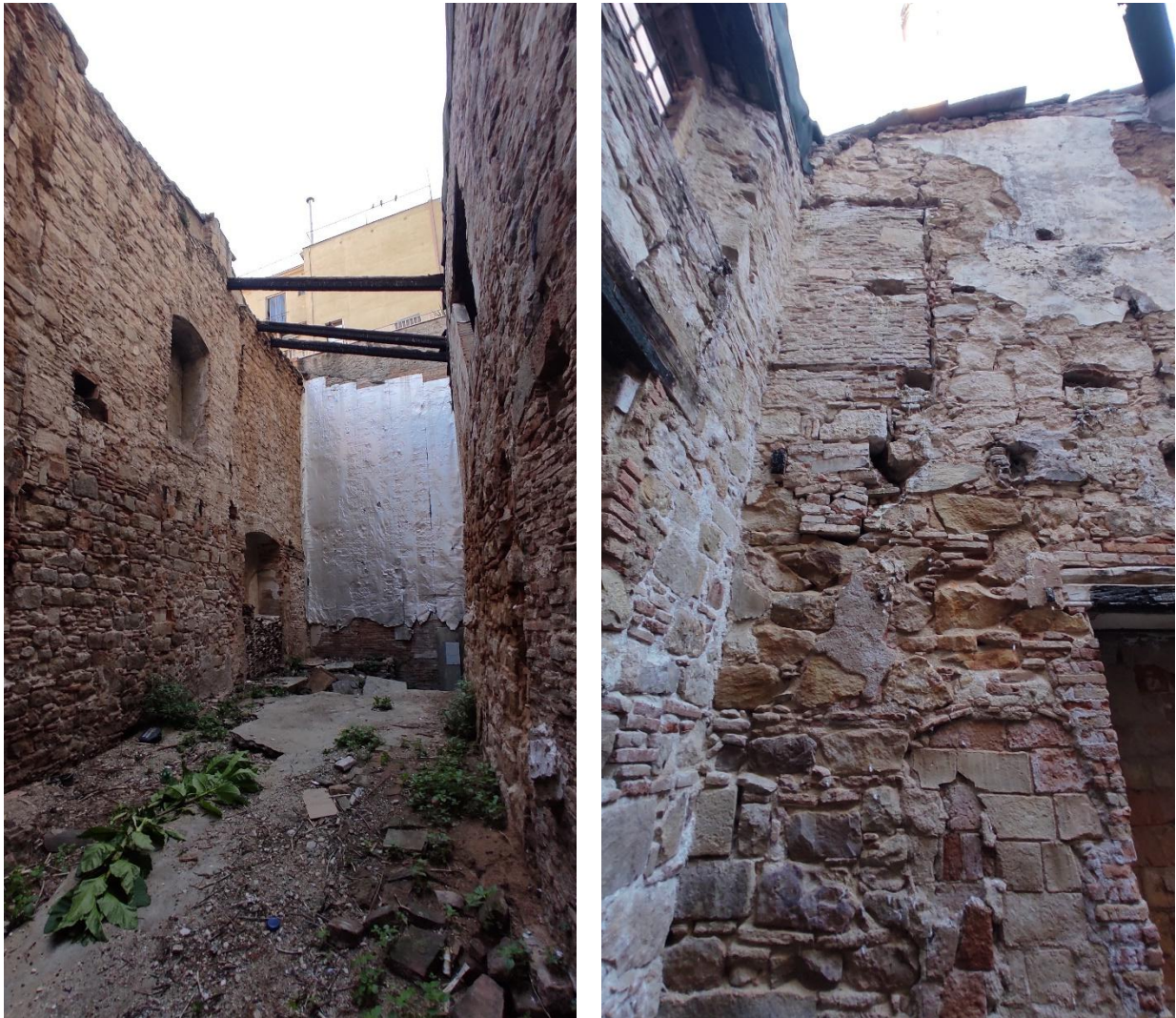
Figures 4 a 13. Definició del es principals disfuncions de la construcció del C/Mosques 9..
