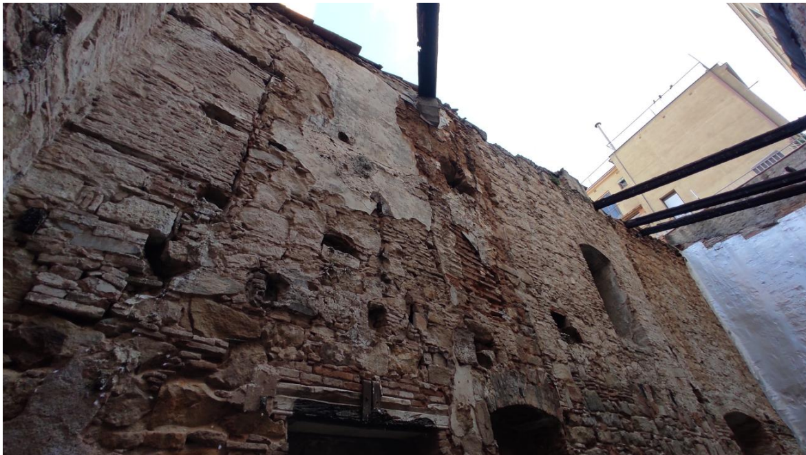
Figura 3. Disfuncions detectades en l'interior de l'edificació.
