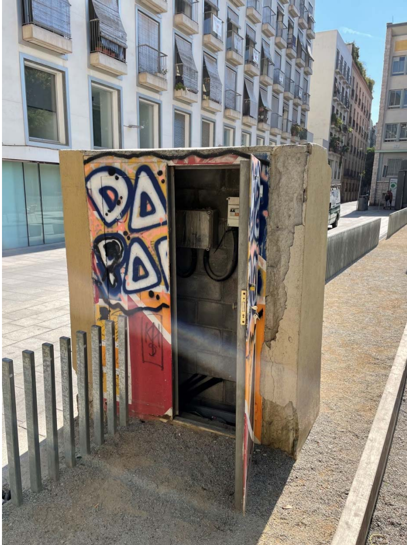
Armari elèctric en desús a enderrocar
