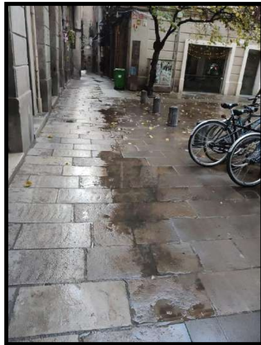
Acumulació d'aigua als aiguafons
