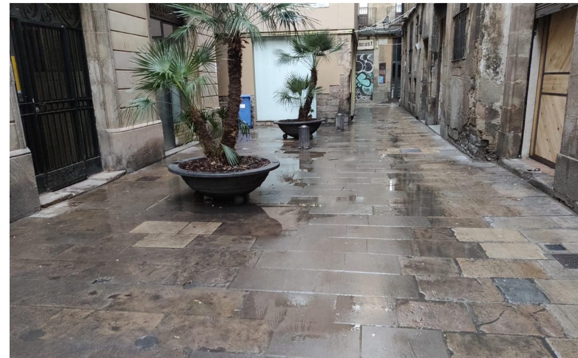
Figura 5. Reparació de paviment en franja central, amb cotes més elevades que el paviment al voltant.
