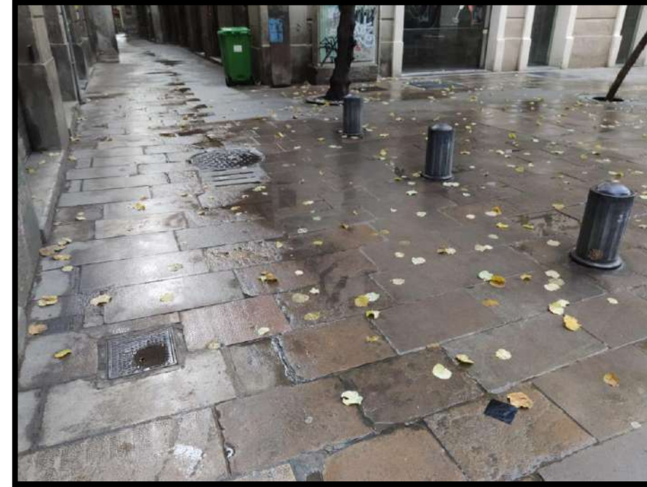
Acumulació d'aigua als aiguafons
