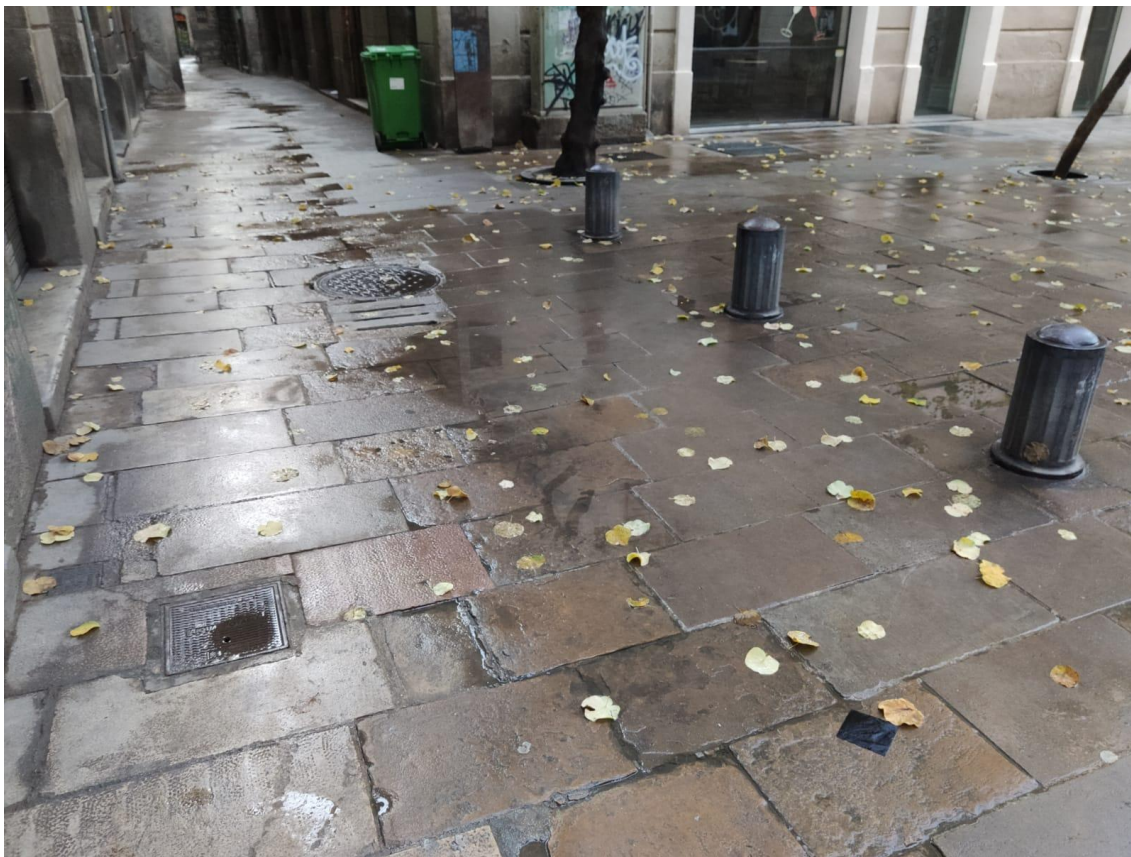
Figura 4. Acumulació d'aigua als aiguafons degut al mal estat del paviment.
