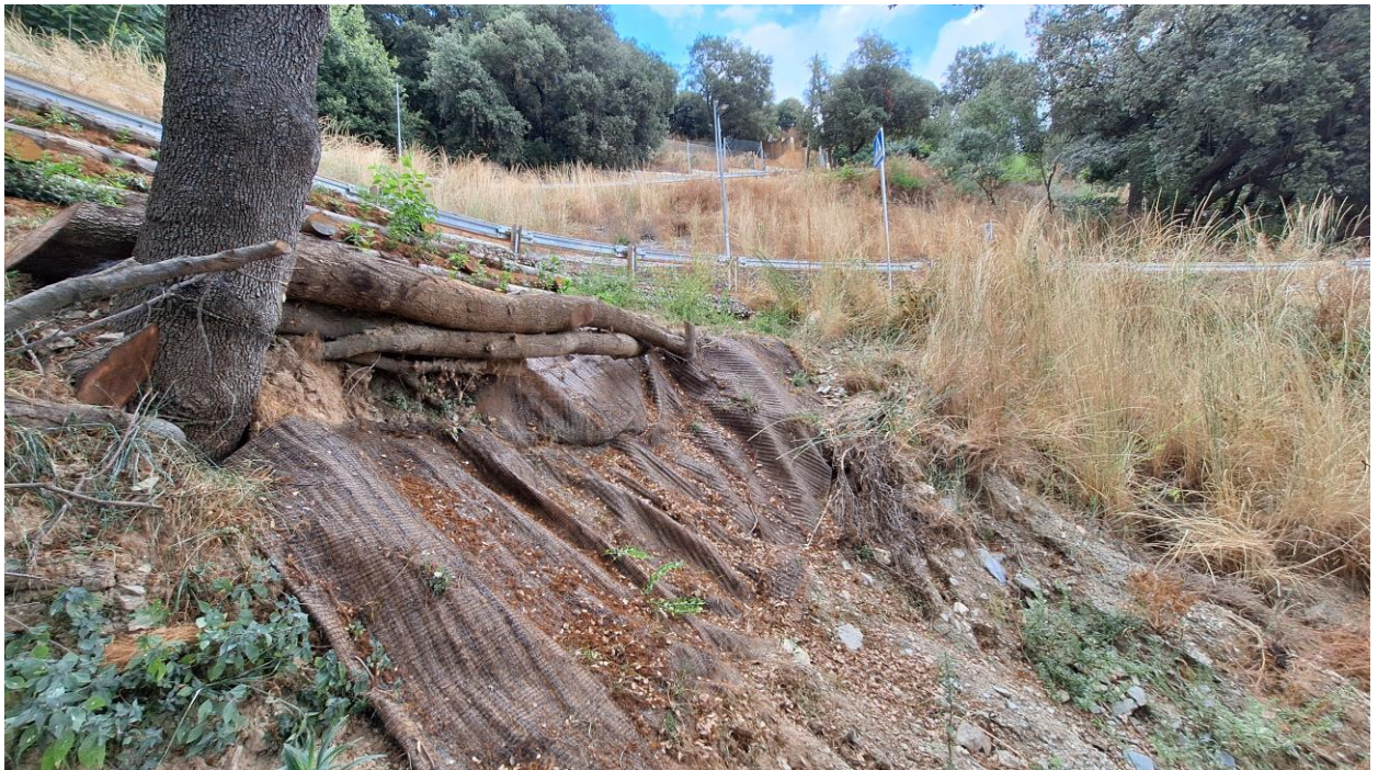
Tram extrem del Krainer amb la palissada buidada i la zona erosionada
