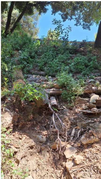
Tram extrem del Krainer amb la palissada buidada i la zona erosionada
