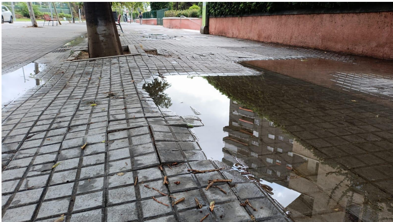
▲ Irregularitats al paviment per efecte de les arrels dels arbres
