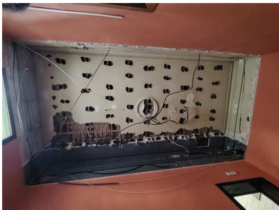
Vistes del sostre original després de l'eliminació del fals sostre
