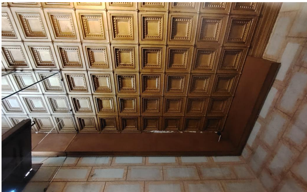
Detall de zona afectada per humitat amb pèrdua de capa pictòrica
