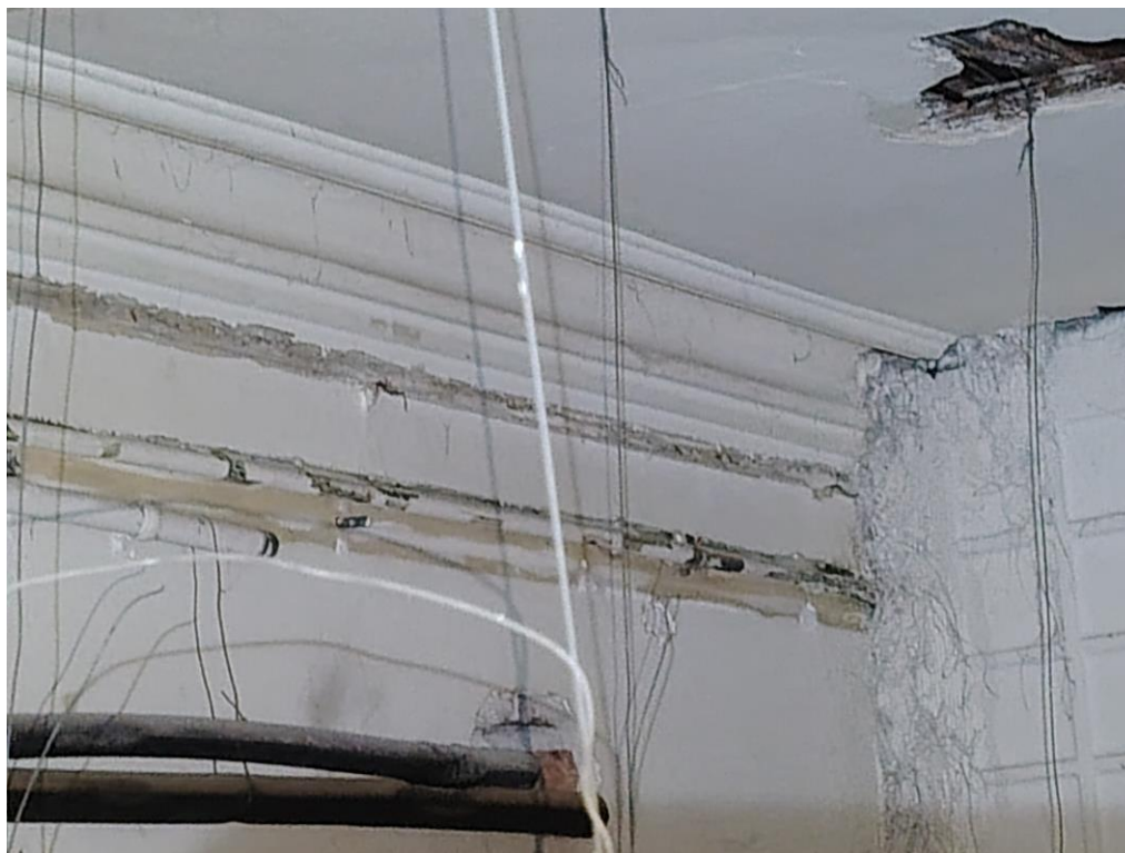
Detalls de motlures i sostre original en mal estat
