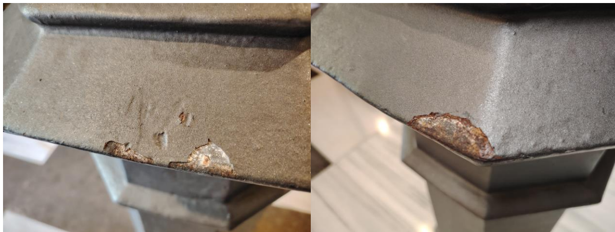
Pèrdues de pintura als pilars
