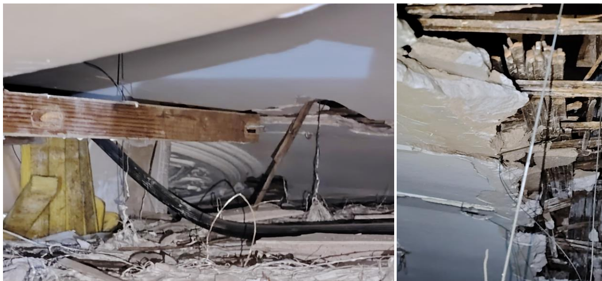
Estat ruïnós del sostre de les oficines al costat del vestíbul
