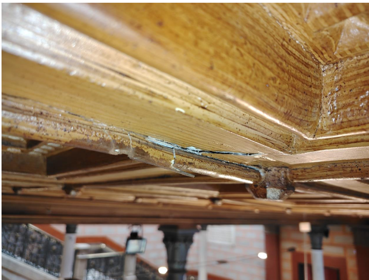
Detall d'esquerdes i zones en perill de despreniment
