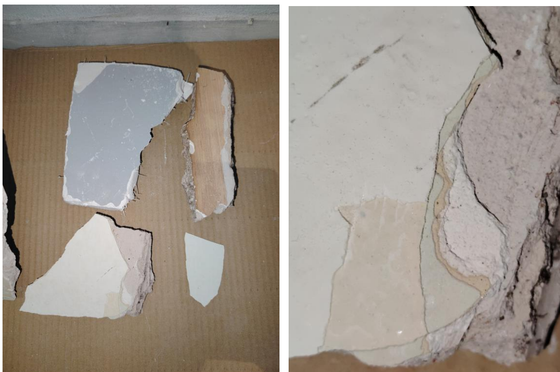
Detalls de fragments del sostre 2 i capes pictòriques, part repintada
