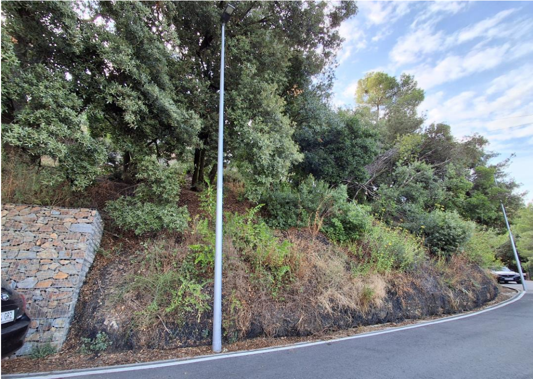
Acumulació de sediments formant bosses, deformació de la malla a la base del talús i obstrucció de la cuneta
