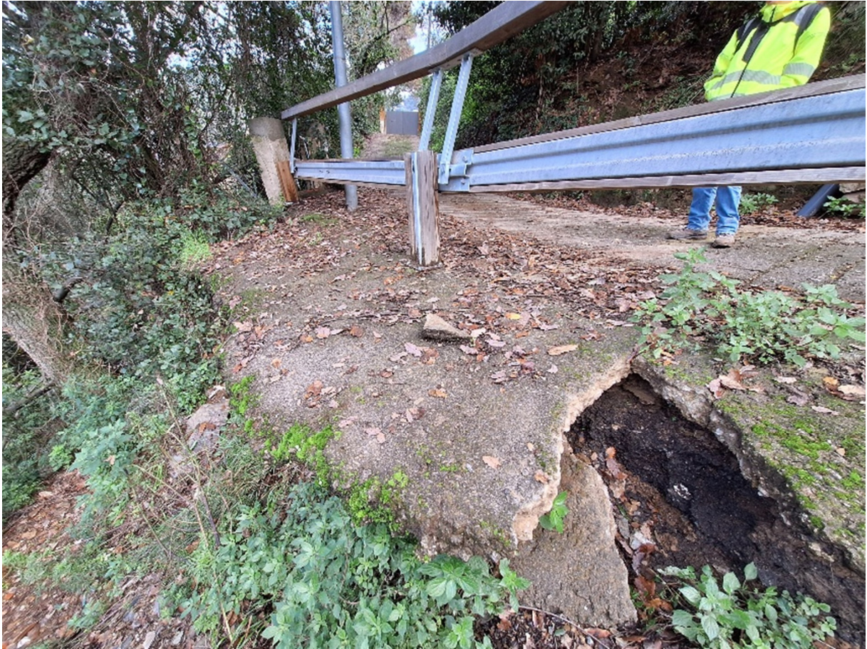
Fotografies de l'estat actual del camí interior de Mas Guimbau: Àmbit A
