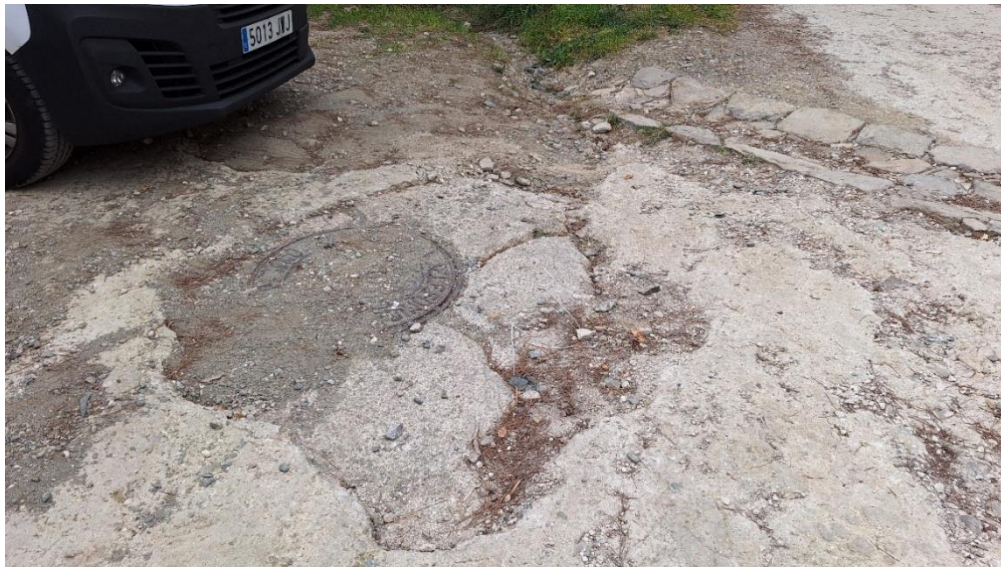
9. Punts amb pegots de paviment que provoquen discontinuïtats i trencament del paviment
