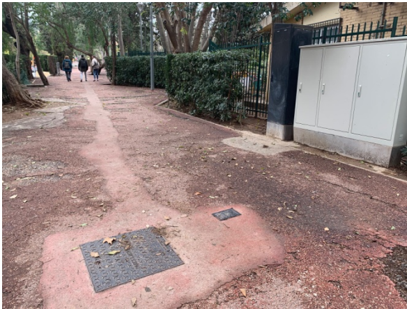
Quadre d'enllumenat i reg existent
