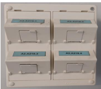
Figura 10. Caixetins existents a les parets dels mòduls, caldrà ubicar-los dins del nou rack.
