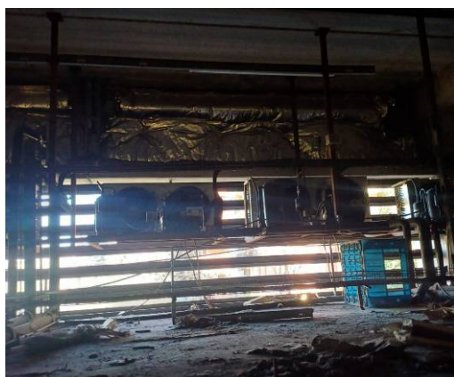
Unitats exteriors existents, compressors
