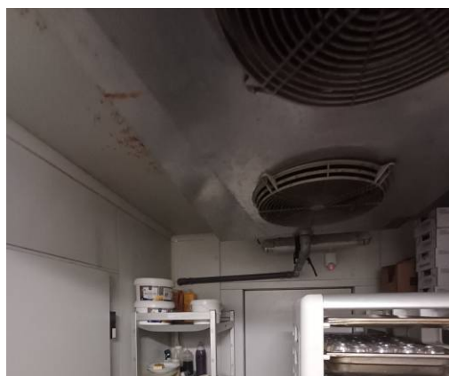
Unitats interiors en càmera friaorífica existent.
