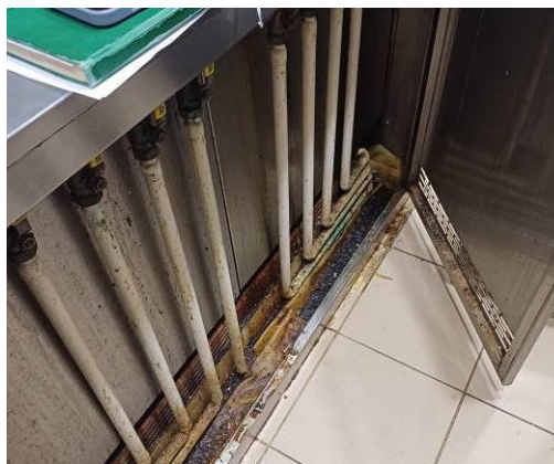
Alimentació de gas elements de cocció
