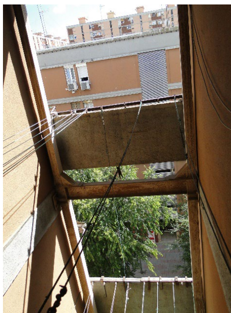
Imatge 7. Vista dels reforços de traba realitzats en la façana del c/ Trapani.
