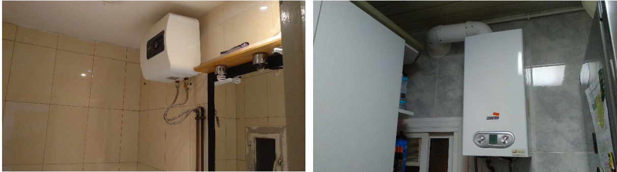
Imatge 31-32. Diferents instal·lacions d'ACS.
