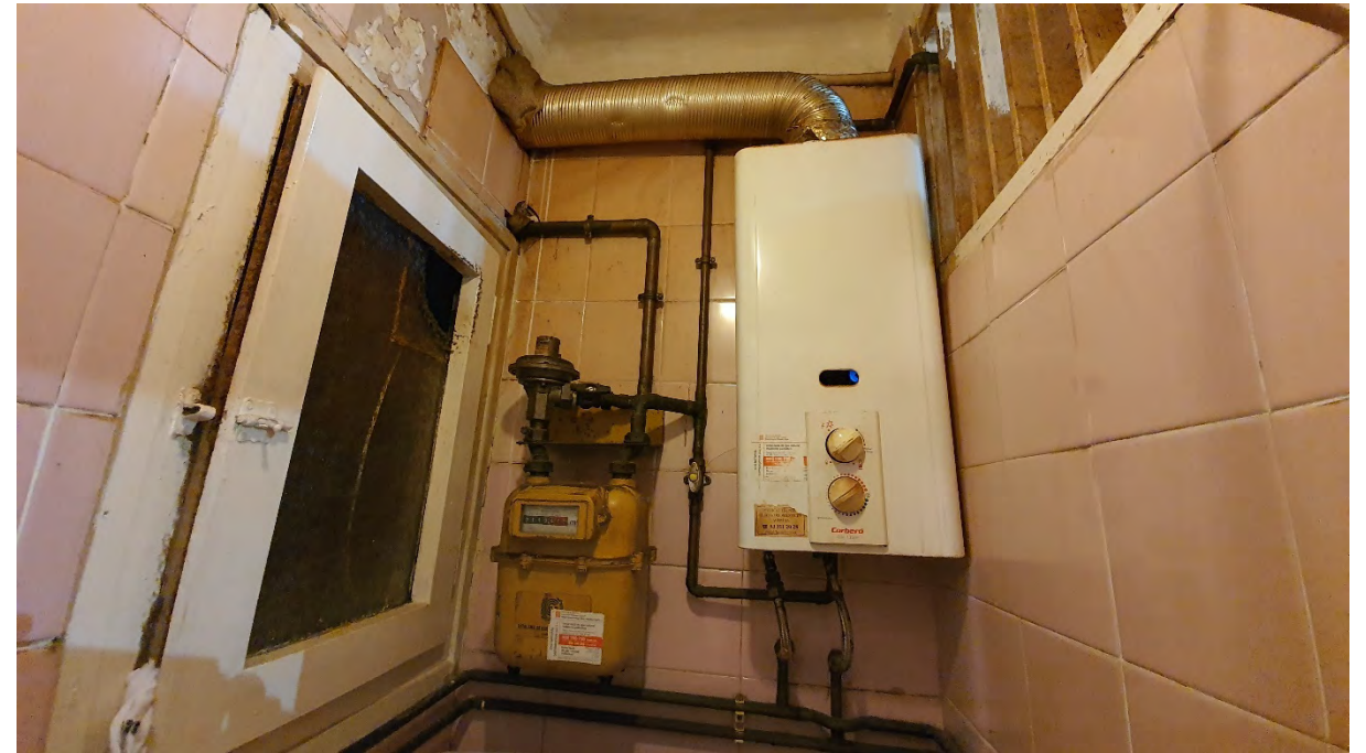
Imatge 28. Vista dels Diferents instal·lacions de gas.
