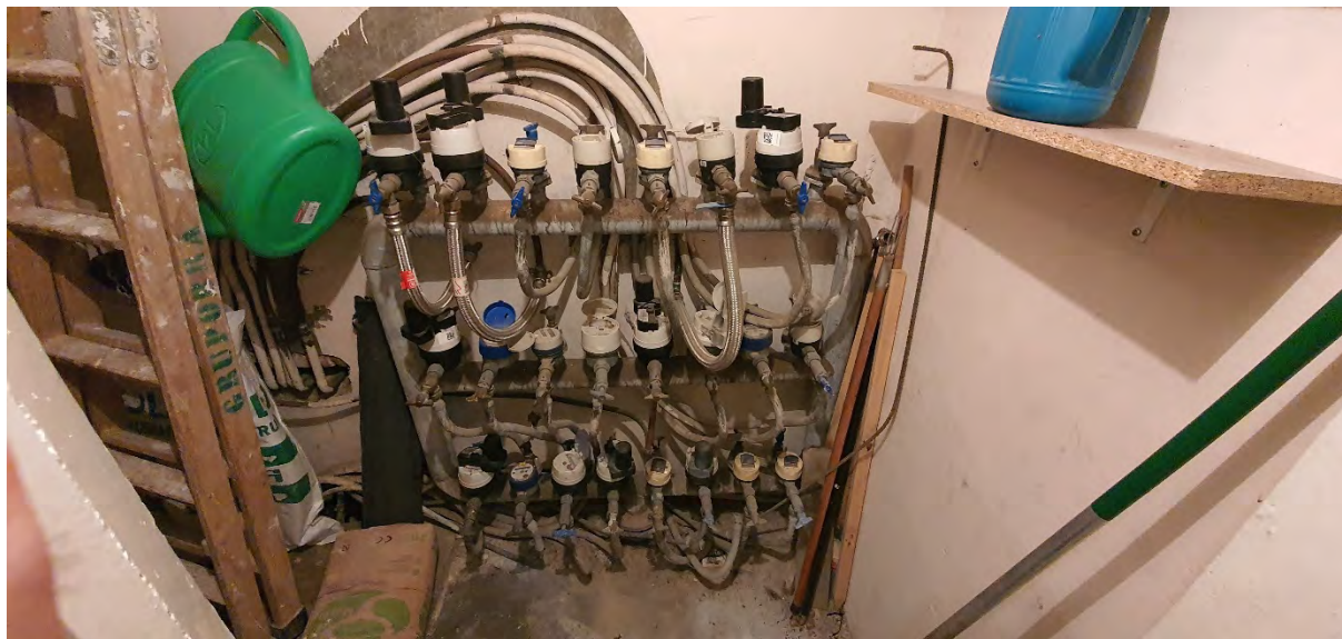
Imatge 27. Vista de la bateria de comptadors.
