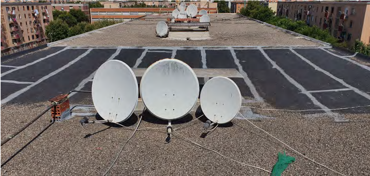
Imatge 31. Vista de antenes parabòliques a coberta.
