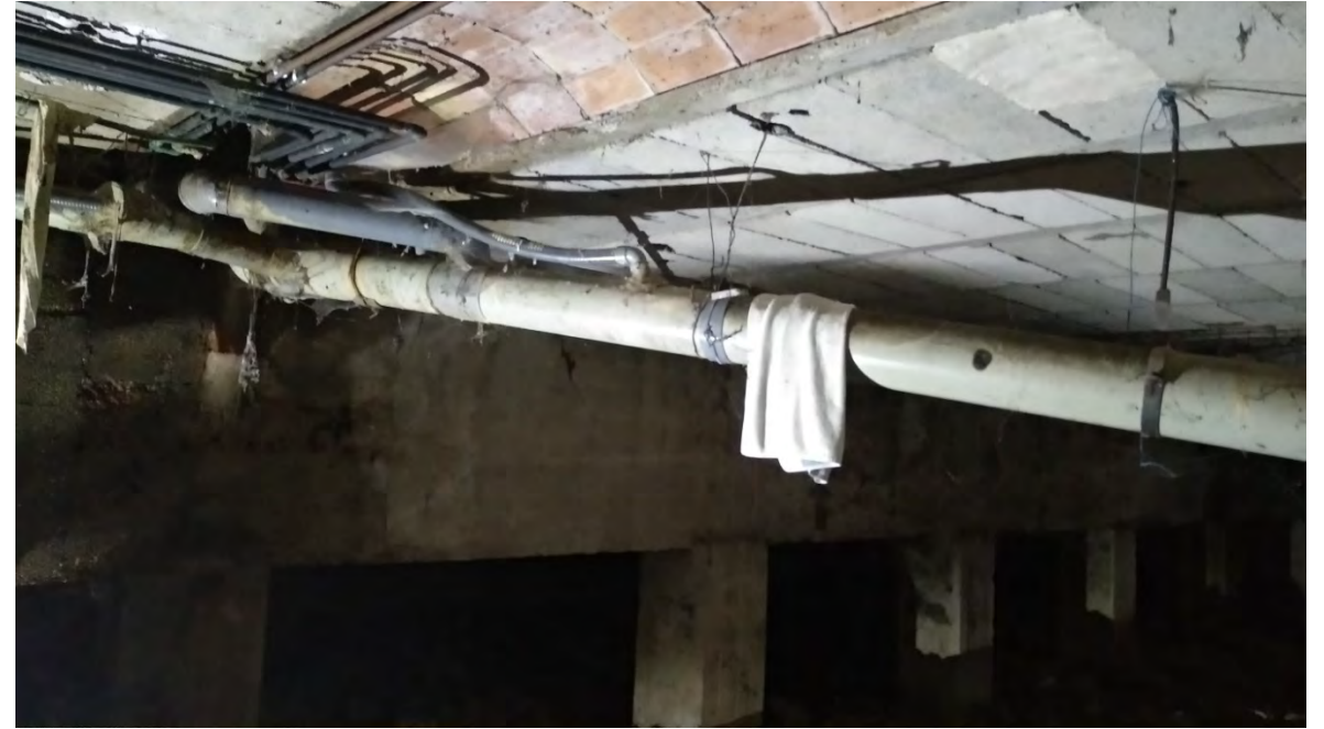
Imatge 24. Vista de la xarxa de sanejament.
