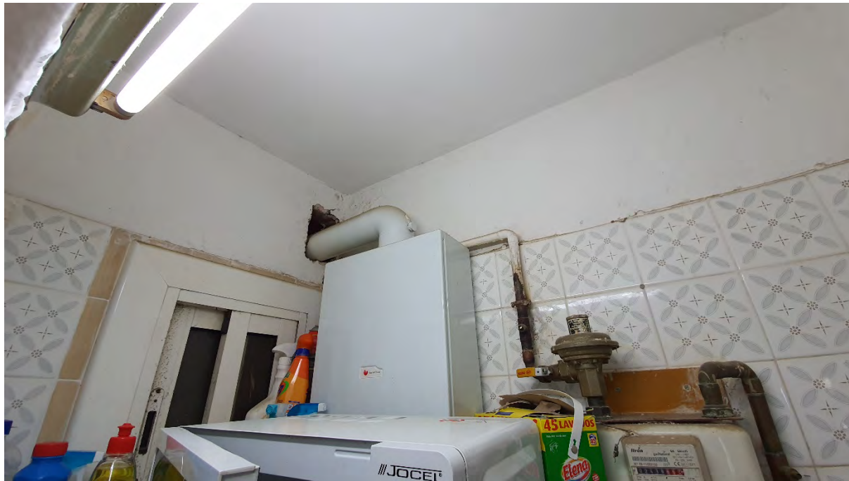
Imatge 30. Ventilació de campanes extractores en els patis d'instal·lacions.
