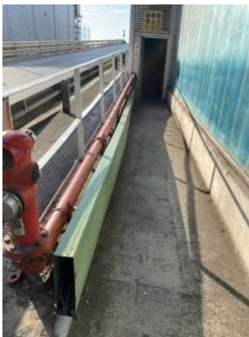
Fig.4.- Bandeja eléctrica lateral que comunica la zona de báscula con la planta de osmosis y la sala de control de la PVE.
