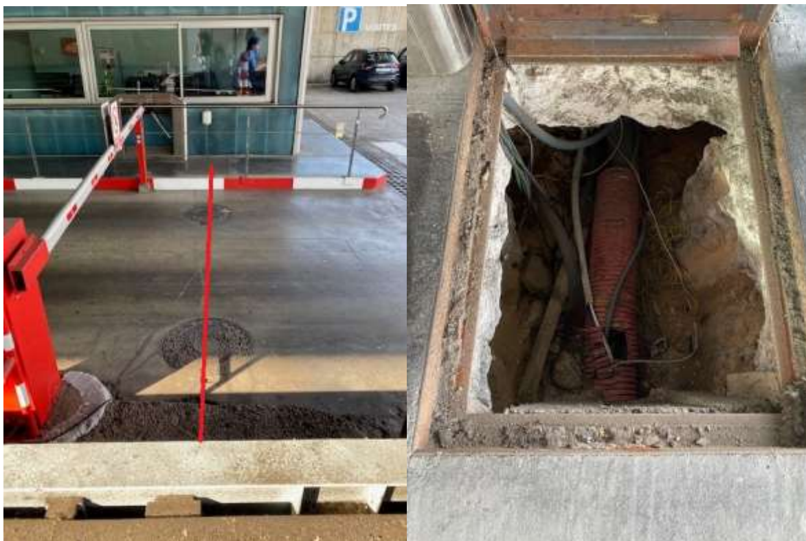
Fig.6.- Paso de cableado de báscula hasta la garita de control de accesos
